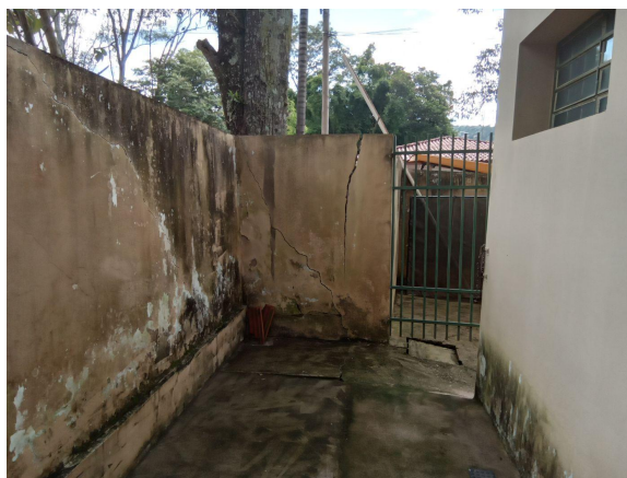
Rachadura vista de longe
