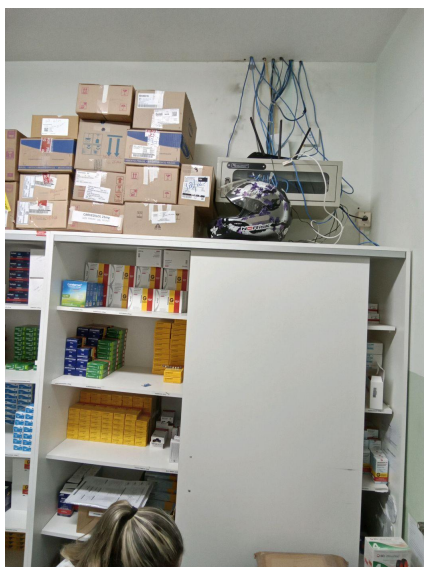
cabos na sala de remédios
