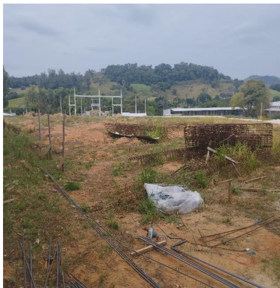
Foto 02 – Materiais expostos às condições climáticas, sem nenhum tipo de proteção.
