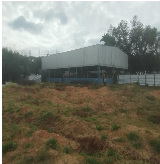
Foto 03 – Mato crescendo no local da obra.
