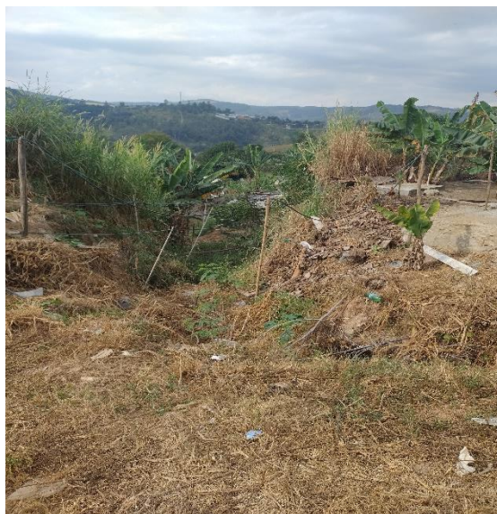
Foto 04 – Vala formada por erosão próxima a residência.
