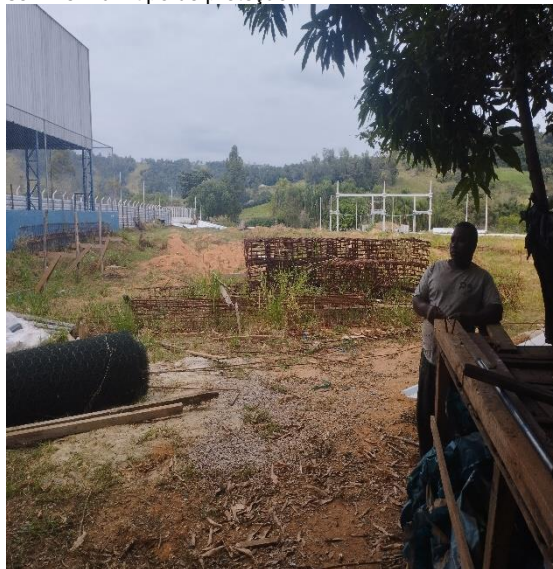
Foto 04 – Funcionário da contratada sem EPI.
