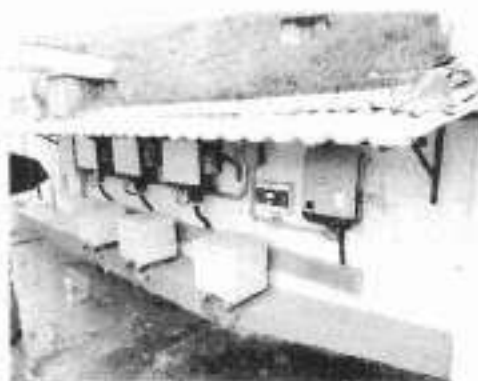
Foto N. 56 - Central de Energia Fotovoltaica.
