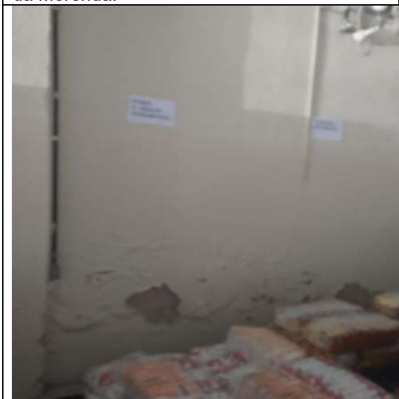
Foto 03: Paredes com sinais de infiltração, tinta descascada.
