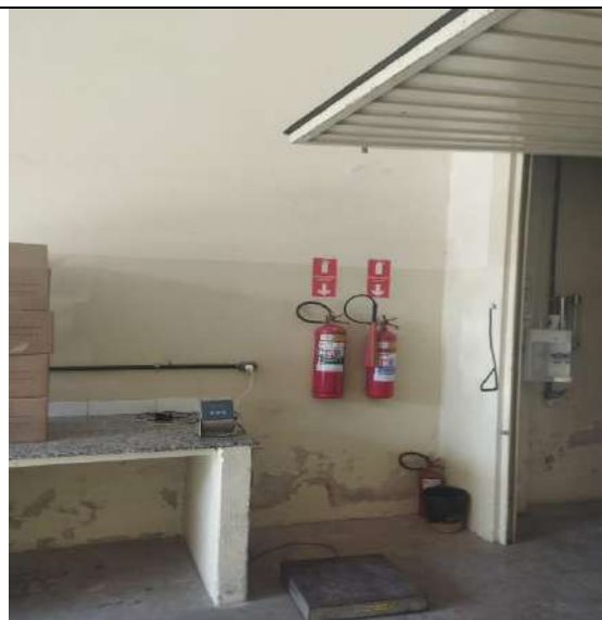
Foto 04: Extintor colocado no chão atrás do lixo a direita. Fora das normas de segurança.
