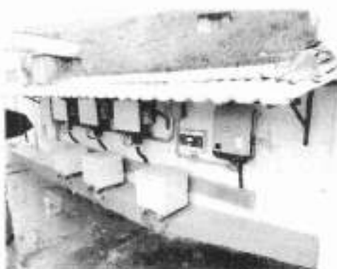
Foto N. 56 - Central de Energia Fotovoltaica.
