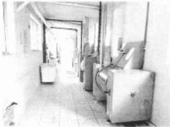
Fotos N. 45, 46, 47 e 48 – Lavanderia – Áreas Internas e Equipamentos.
