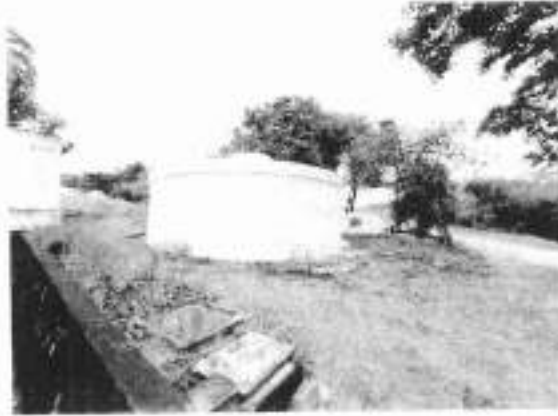
Foto N. 75 – Caixa D'água Externa de Alvenaria com capacidade de 100.000 Litros.
