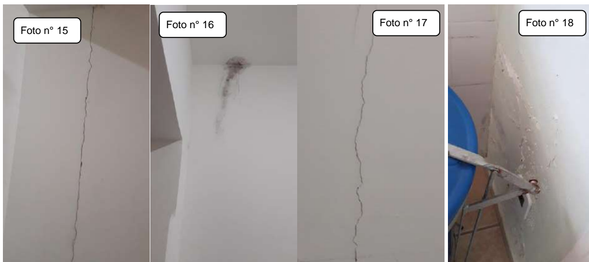
Fotos nº 15 a 18 – Paredes de algumas salas e corredores com rachaduras e sinais de umidade e infiltração – necessidade de manutenções.
