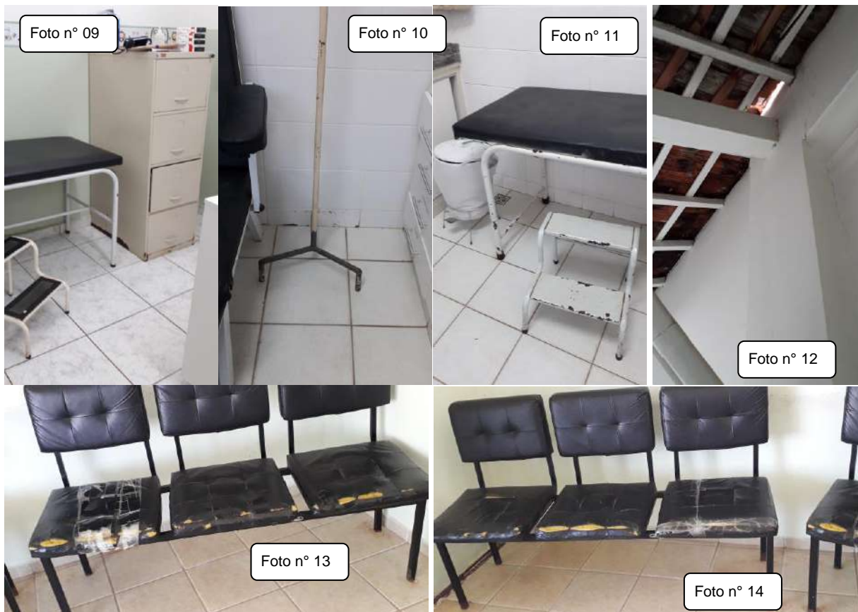
Fotos nº 09 a 114 – Mobiliário com sinais de ferrugem, bem como cadeira (longarinas) da recepção em péssimo estado (rasgadas), algumas “consertadas” com fita adesiva.
