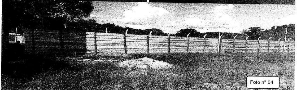
Fotos n° 02 a 04 – Na data da visita realizada em 11/04/2023, verificamos a existência de tapumes e realização de algumas obras de infraestrutura iniciadas, porém sem continuidade.
