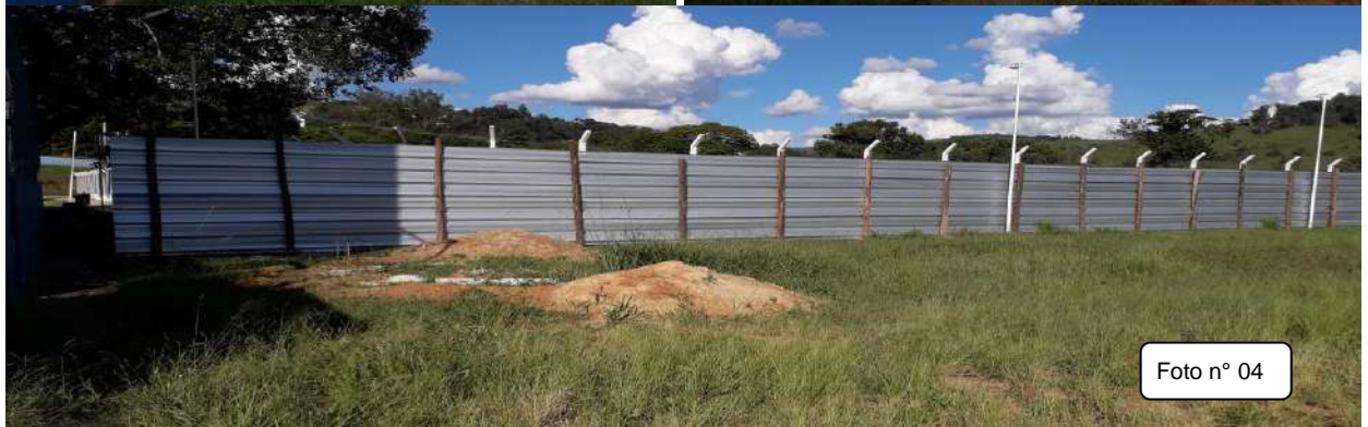
Fotos n° 02 a 04 – Na data da visita realizada em 11/04/2023, verificamos a existência de tapumes e realização de algumas obras de infraestrutura iniciadas, porém sem continuidade.
