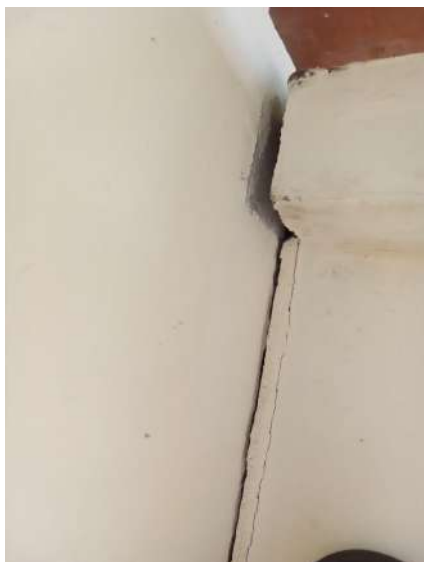
rachadura depósito gás
