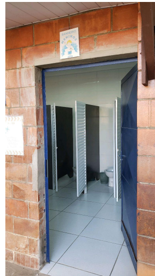
Baheiro masculino com problema hidráulico
