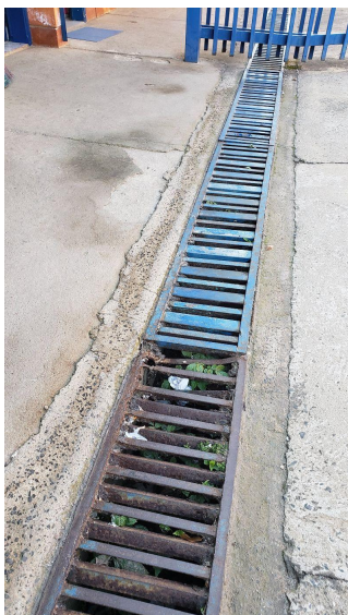
Grades do ralo danificadas
