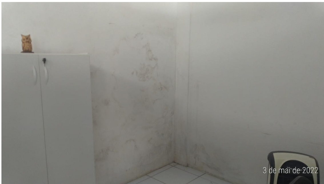
Foto 3 – Paredes manchadas que denotam infiltrações no local.
