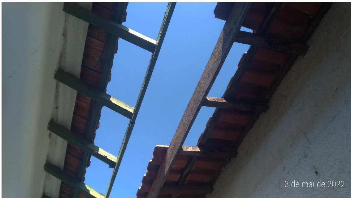
Foto 5 – Telhado com telhas faltantes.
