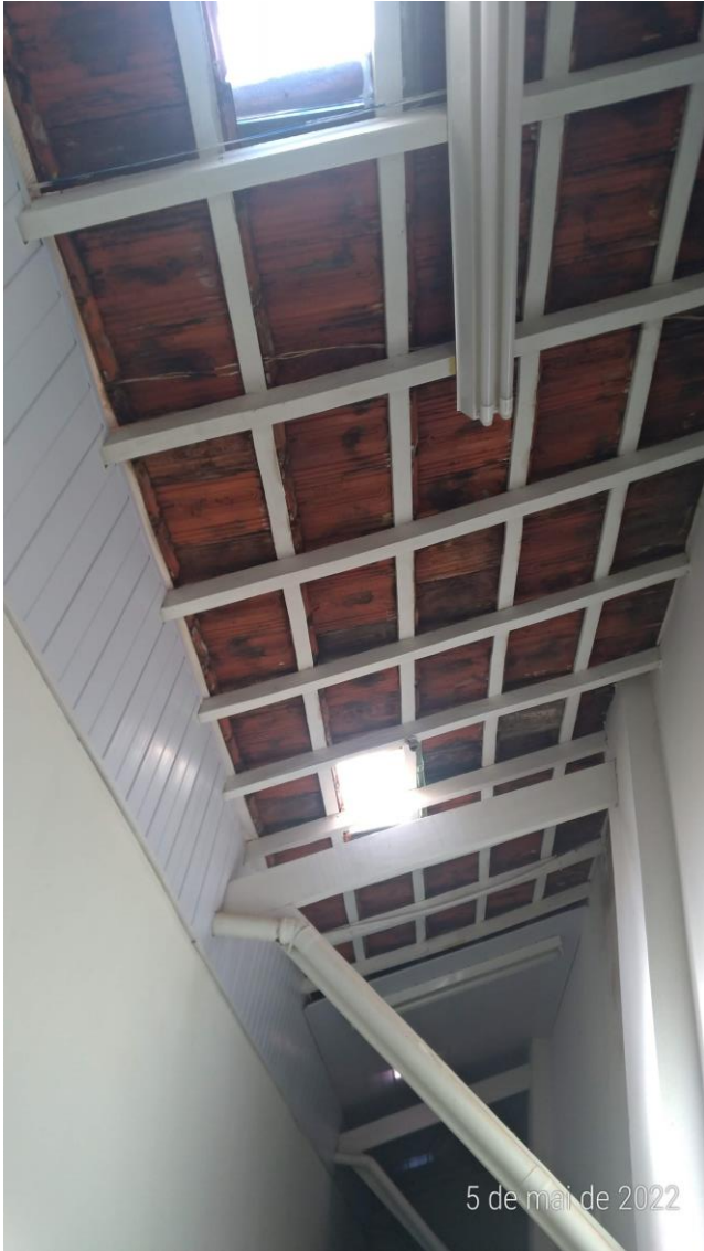
Foto 15 – Telhado com necessidade de reparos.
