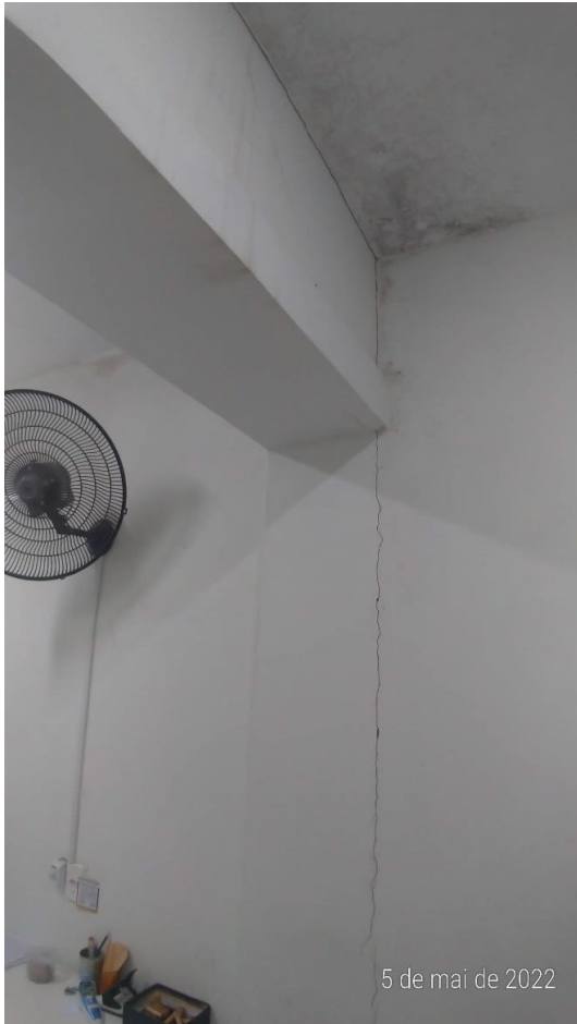
Foto 10 – Parede trincada e teto mofado.
