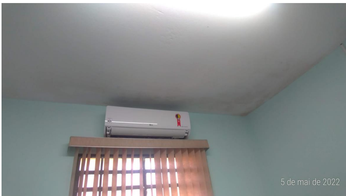
Foto 8 – Teto com sinais de infiltração e mofo.
