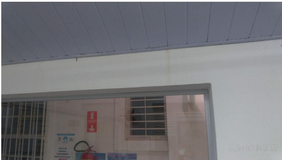
Foto 7 – Sinais de vazamentos no teto.
