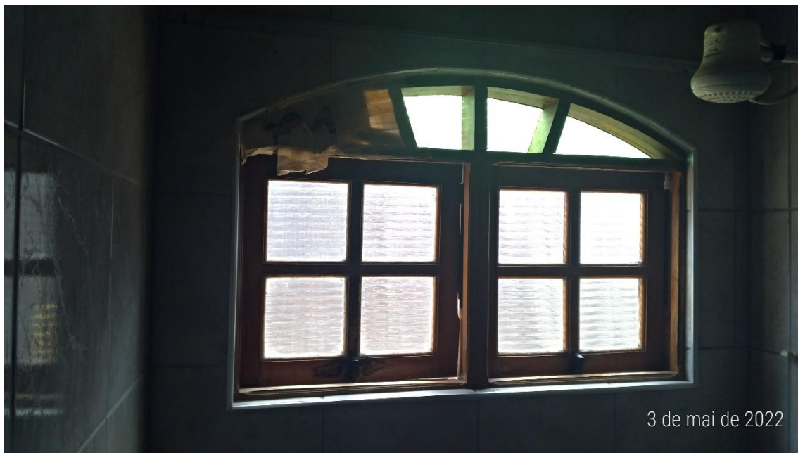
Foto 05 – Janela com vidro quebrado e com fechamento em papelão
