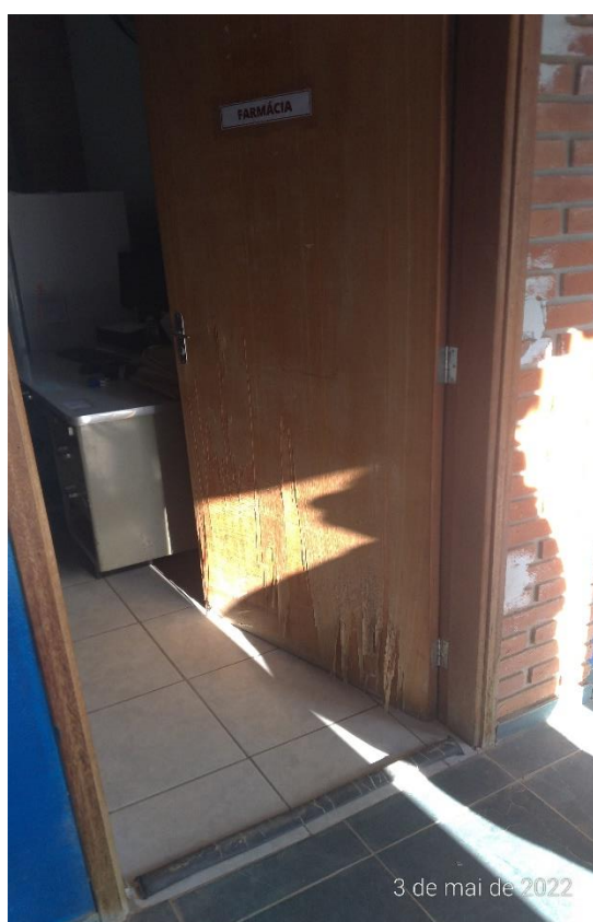
Foto 14 – Porta da USF danificada.
