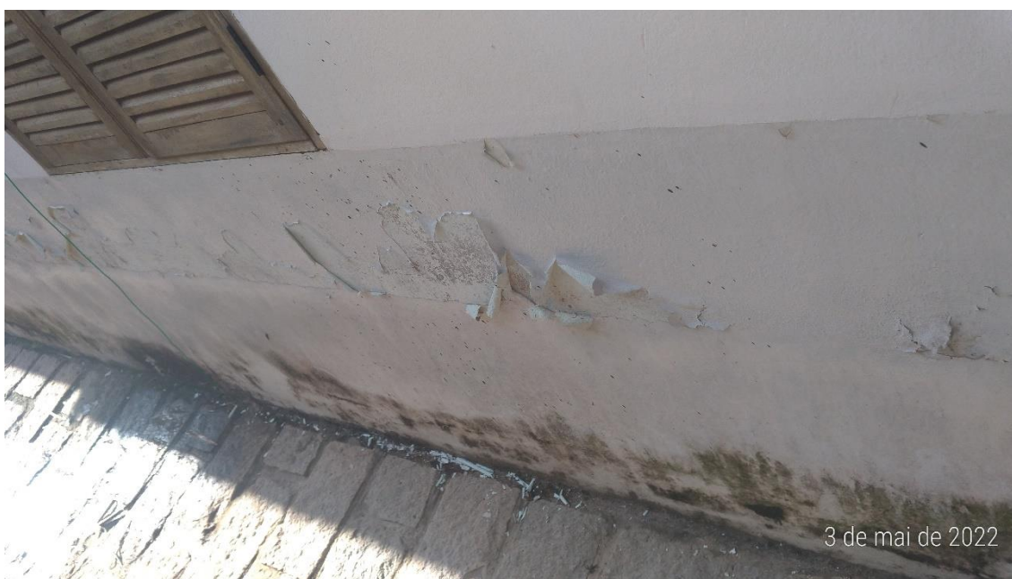
Foto 10 – Parede externa da unidade com sinais de mofo e descascada
