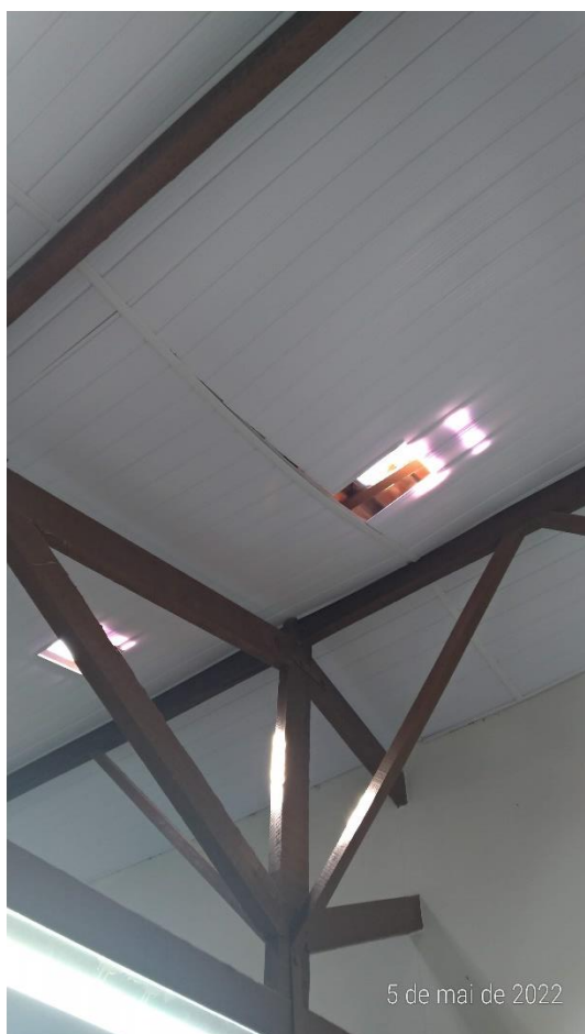
Foto 8 – teto com necessidade de reparos
