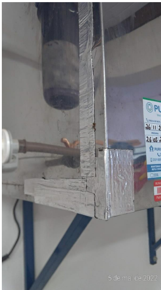
Foto 4 – Filtro colado com fita e com vazamento.
