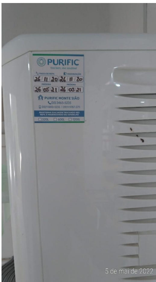
Foto 15 – Elemento filtrante do bebedouro com troca vencida
