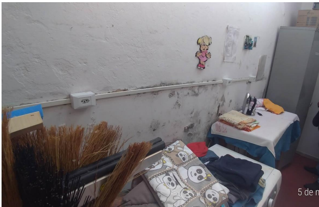
Foto 13 – Paredes mofadas e descascadas.
