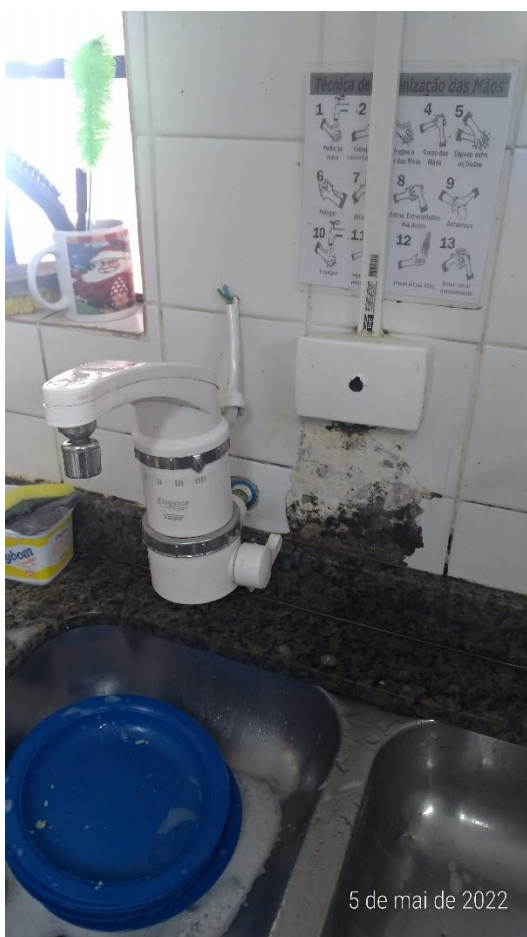
Foto 14 – revestimento da cozinha danificado.
