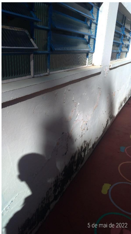
Foto 9 – Parede externa com necessidade de reparo.
