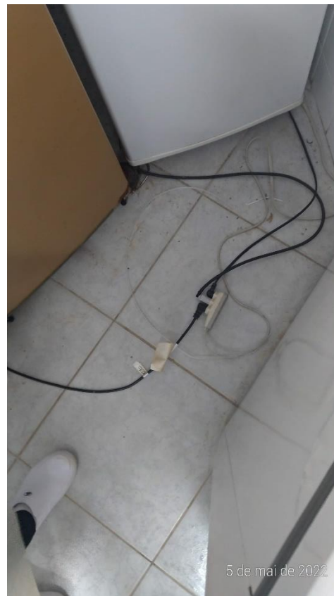
Foto 12 – Inadequação da rede elétrica da cozinha
