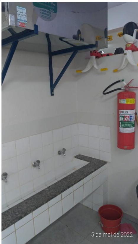
Foto 5 – Balde aparando vazamento do bebedouro.
