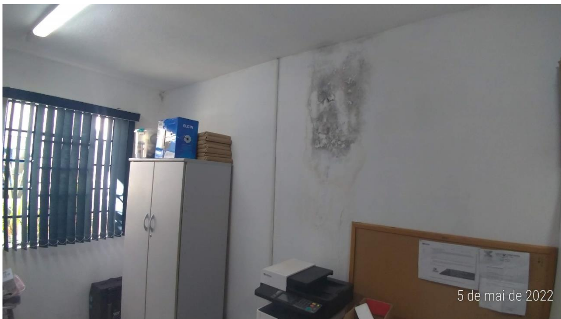
Foto 1 – Sala da coordenação com parede mofada.
