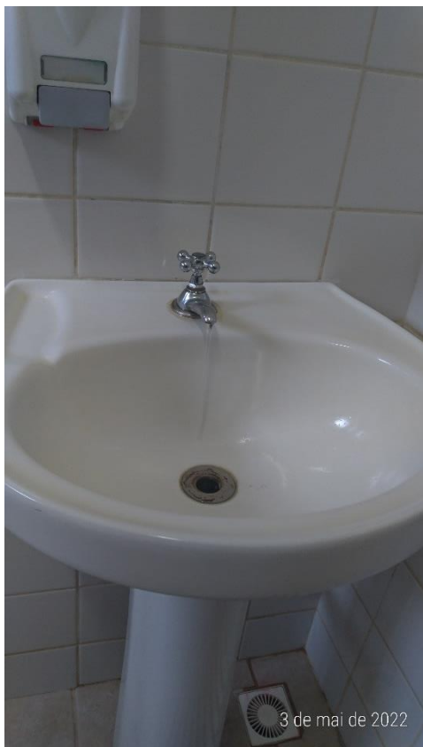
Foto 2 – Torneira com vazamento.
