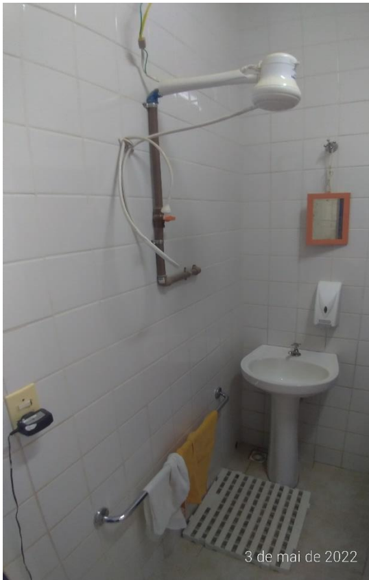
Foto 6 – Chuveiro improvisado na entrada dos banheiros
