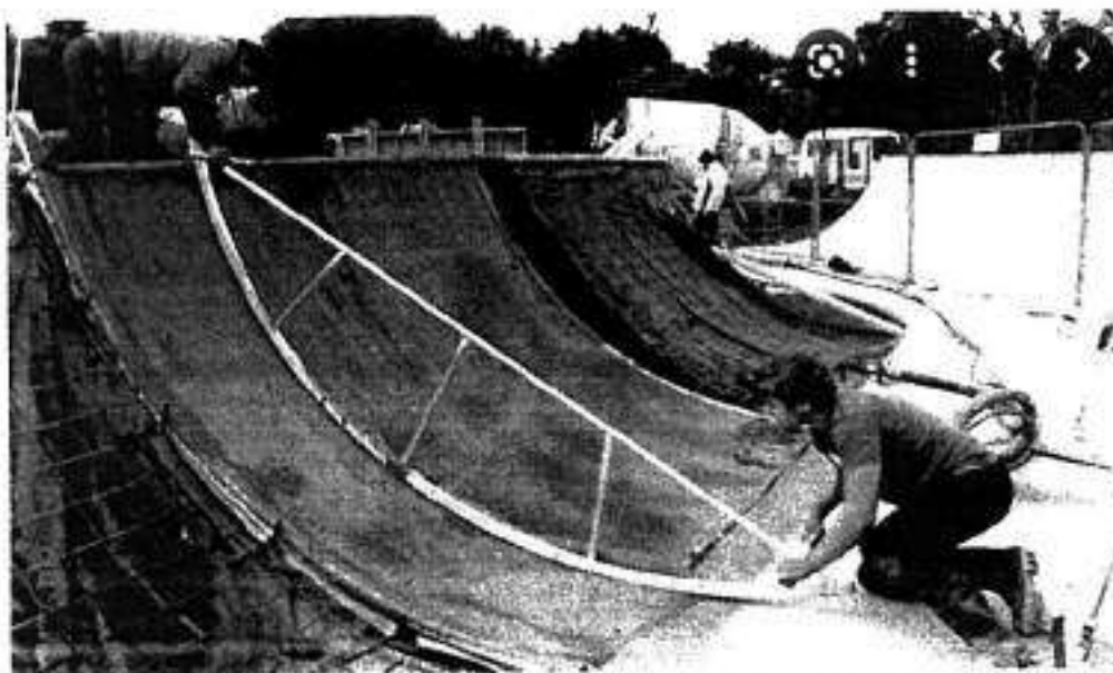
Imagem 10 Profissionais fazem corte do concreto utilizando a regua com o raio escolhido.
