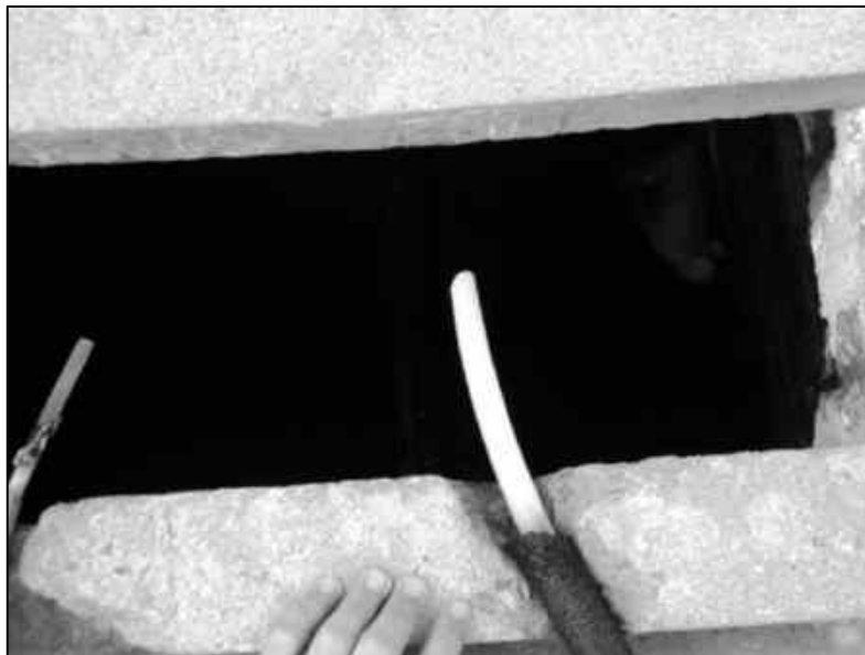
Figura 2.88 – Acesso ao tanque de contato de ácido fluossilícico e carbonato de sódio.
