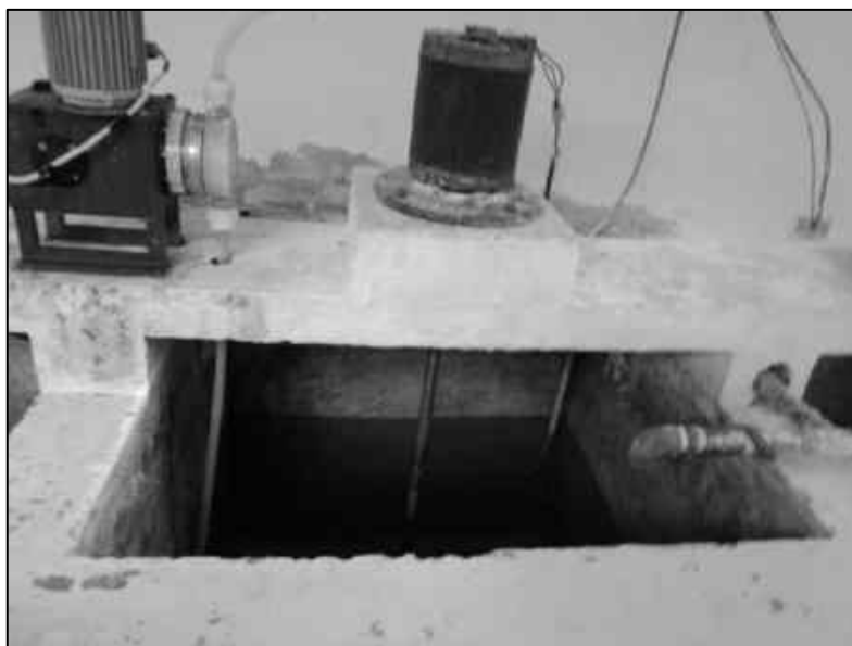
Figura 2.90 – Tanque misturador de carbonato de Sódio e bomba dosadora.
