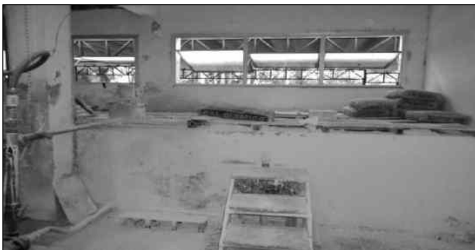
Figura 3.3 - Depósito provisório de Cal na ETA I.
