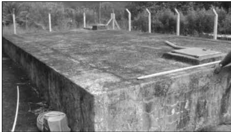
Figura 2.122 – Reservatório “Gregório da Silva” Jd. Cachoeira – Abastecido por Caminhões Pipa.
