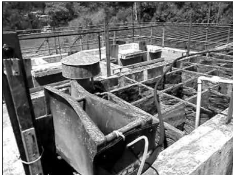
Figura 2.85 – Calha Parshall e conjunto de Chicanas.
