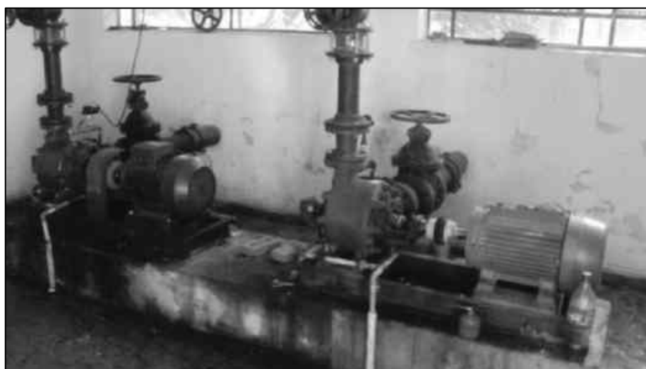
Figura 2.54 – Conjunto Motor bomba da Linha de Recalque Jd. Brasil.
