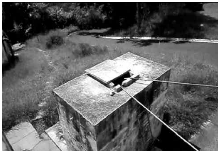
Figura 2.89 – Tanque de Contato ETA III.
