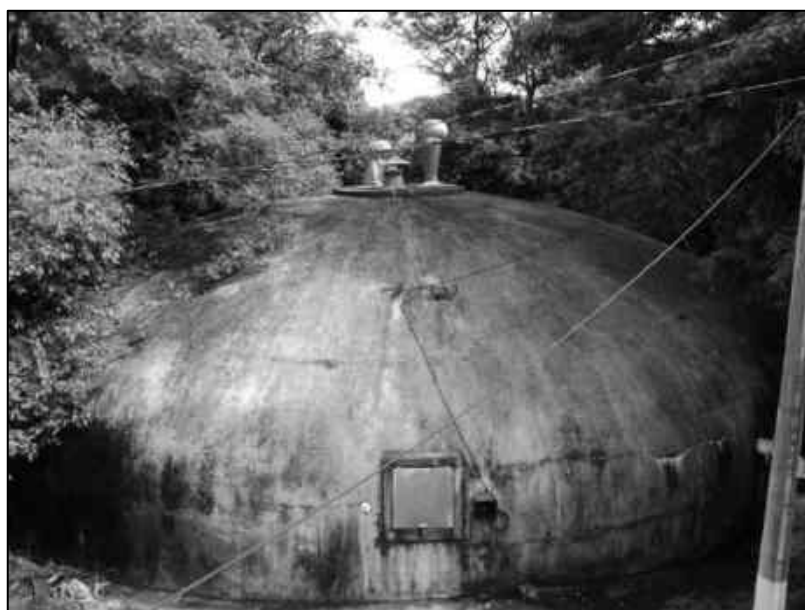
Figura 2.20 – Reservatório R2 – 1000 m 3 - ETA I - Parque Dr. Arruda.
