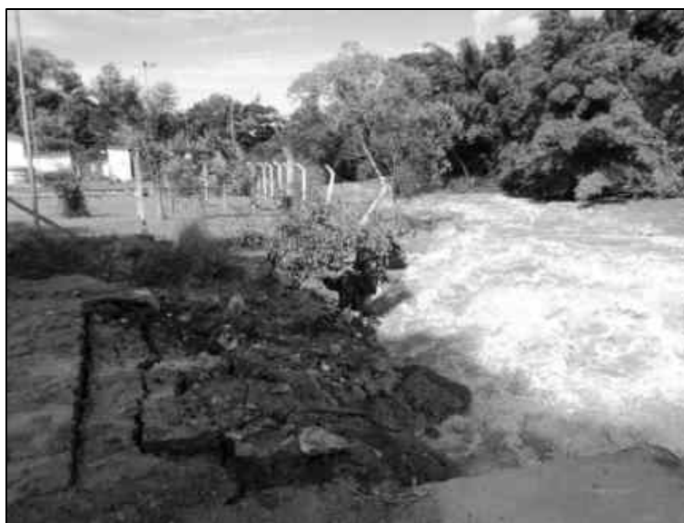
Figura 2.1 – Ponto de Captação da ETA I e II – Problemas de Desmoronamentos.
