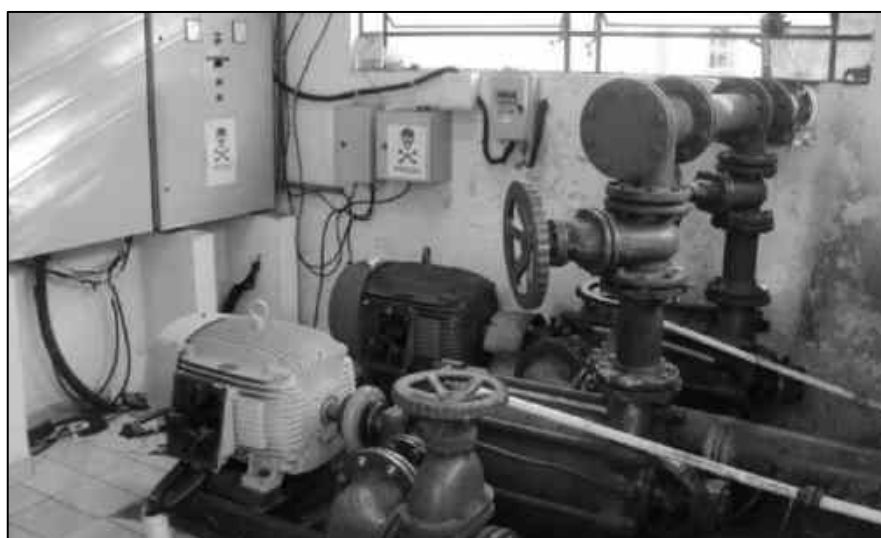
Figura 2.40 - Conjunto motor bomba da estação de recalque Jd. Figueira – ETA I
