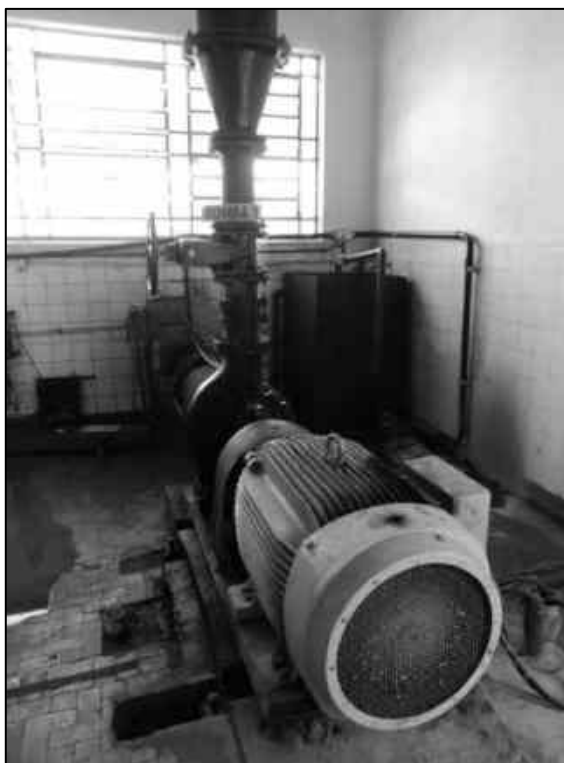
Figura 2.13 - Conjunto motor bomba reserva da ETA II.
