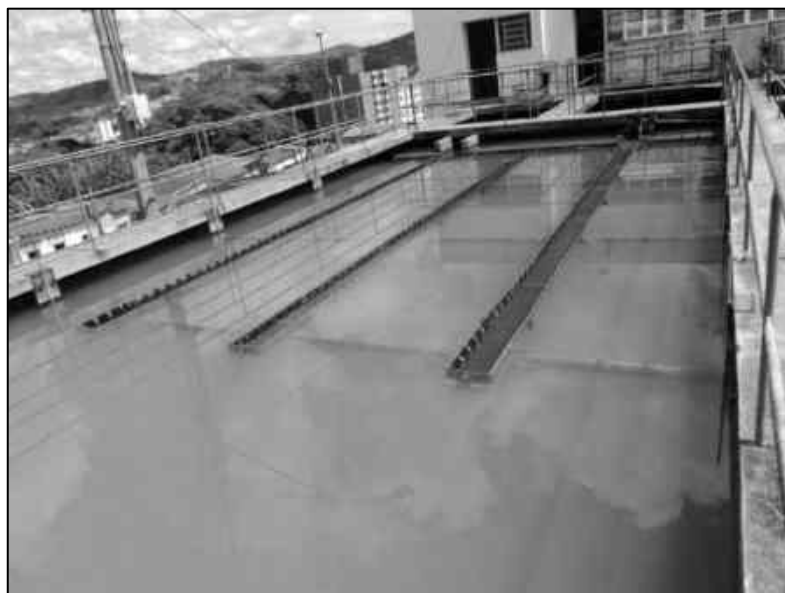
Figura 2.46 - Sistema de Captação Superficial por Canaletas – Tanque de Decantação.
