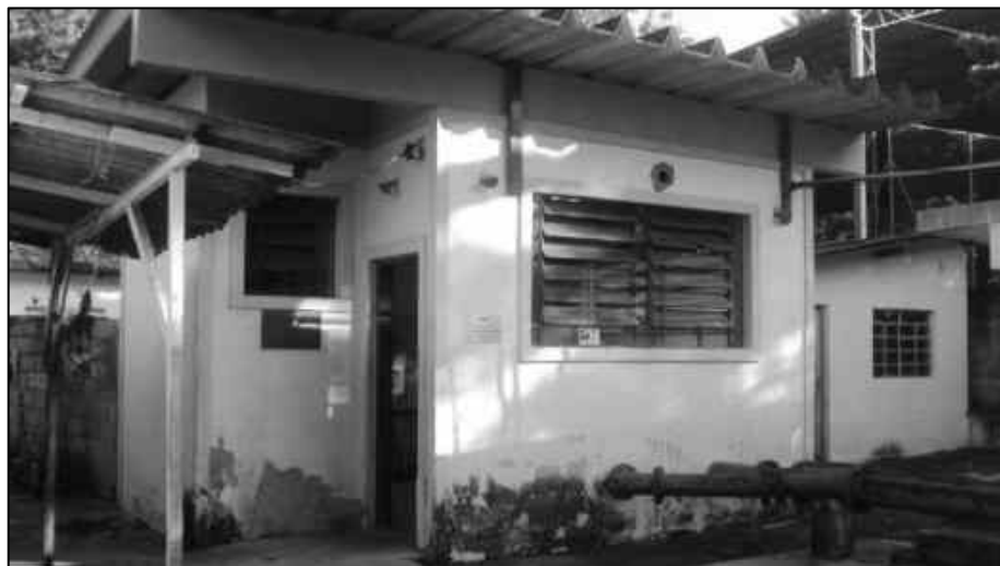
Figura 2.33 – Estação de Recalque do Jd. Figueira – ETA I.
