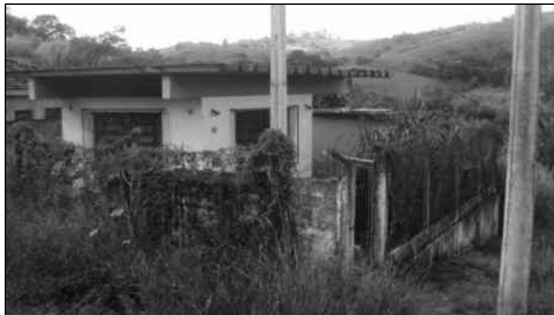
Figura 2.74 – Reservatório de recalque Jd. Silmara (ETA II) – 30 m 3 - Estrutura de Alvenaria.
