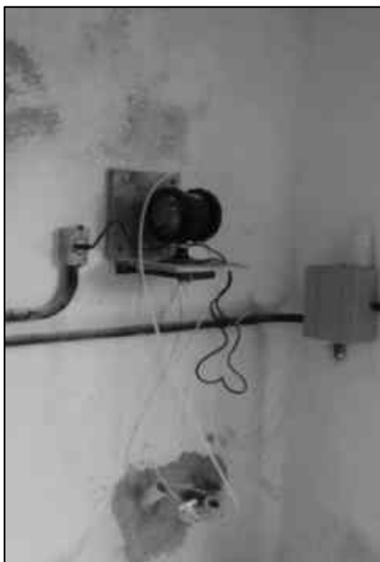
Figura 2.127 – Bomba Dosadora de Cloro – Estância Seabra.
