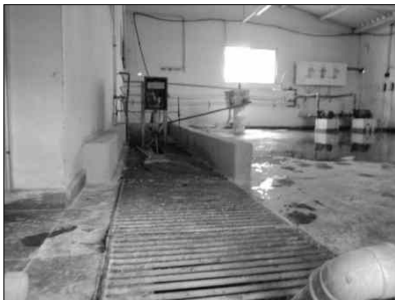
Figura 2.43 - Sala de Pré-cloração e Adição de Cal.
