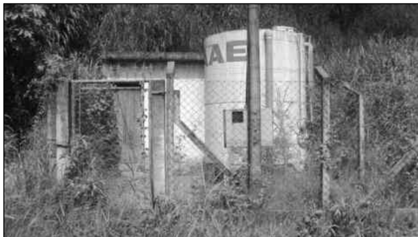
Figura 2.29 – Estação de recalque Parque das Aves (ETA I) – 30 m 3 - Estrutura Metálica.
