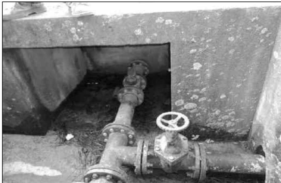
Figura 2.83 – Saída da estação elevatória de água bruta – ETA III.
