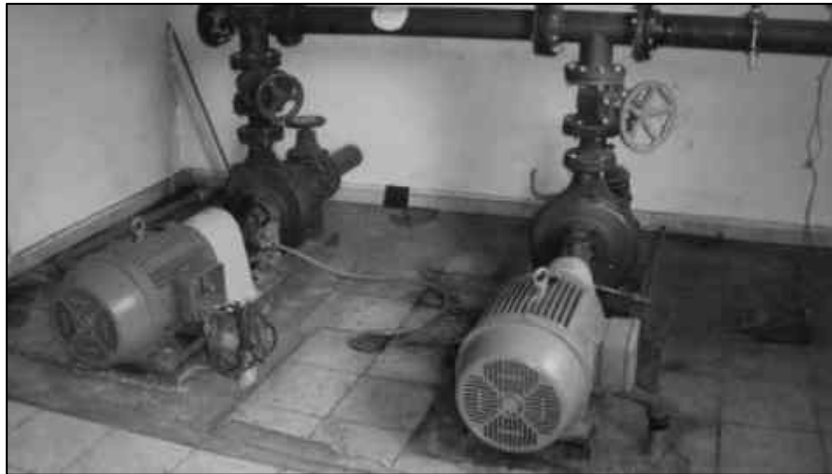
Figura 2.23 – Conjunto Motor Bomba da linha de Recalque Moreirinha.
