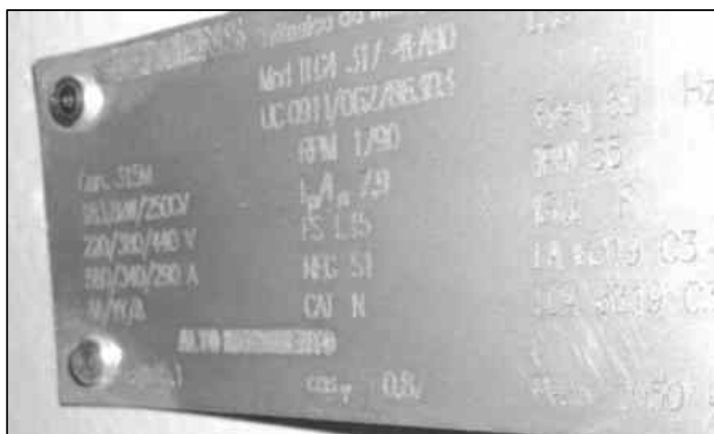
Figura 2.10 - Especificação técnica do conjunto motor bomba em operação da ETA II.
