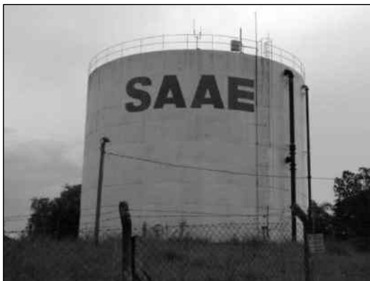
Figura 2.76 - Reservatório Panorama Tropical (ETA II) - 2000 m 3 - Estrutura Metálica.
