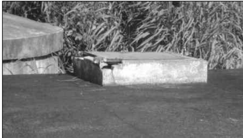
Figura 2.71 - Problemas identificados na estrutura de alvenaria do reservatório Pinheirinho (ETA II) – 200 m 3 .
