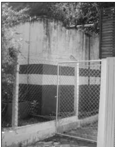
Figura 2.58 – Reservatório de recalque em detalhe – Jd. Nova Amparo.
