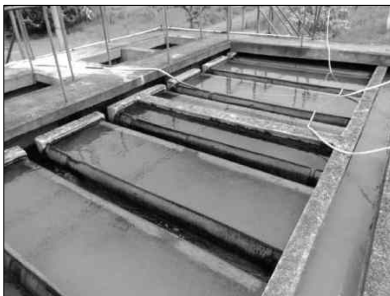
Figura 2.108 - Tanques para floculação e decantação da ETA IV.
