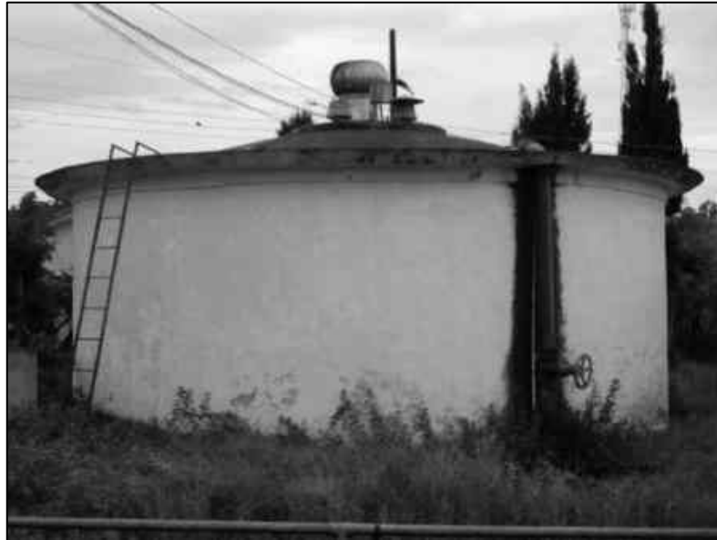
Figura 2.47 - Reservatório circular em concreto (ETA II) - 200 m 3 - Localizado na Rua Carlos de Campos.
