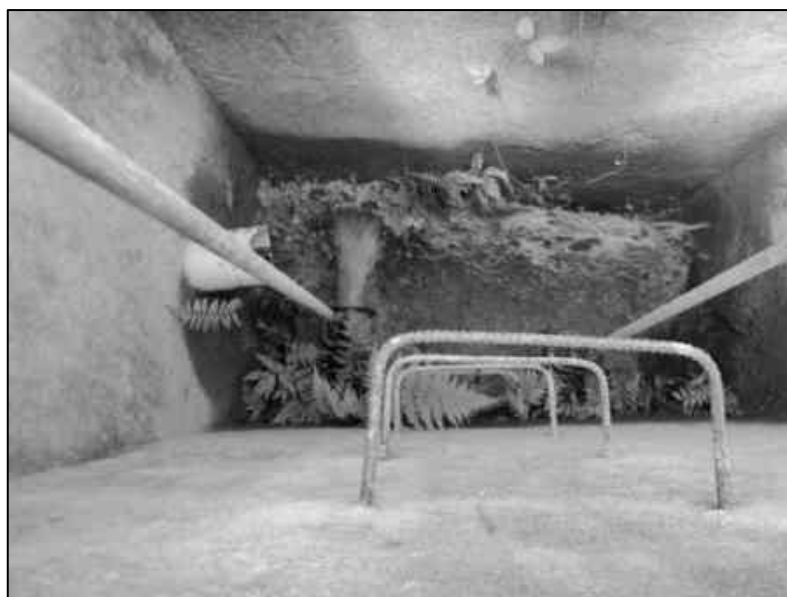
Figura 2.107 - Descarte do lodo realizado pela ETA IV.
