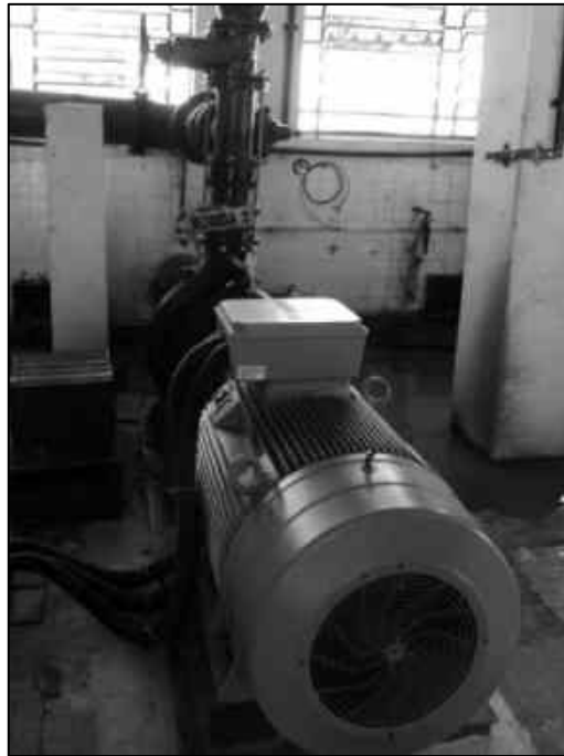
Figura 2.11 - Conjunto motor bomba em operação da ETA II.
