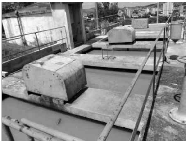
Figura 2.45 - Tanques de Flocculação - ETA II.
