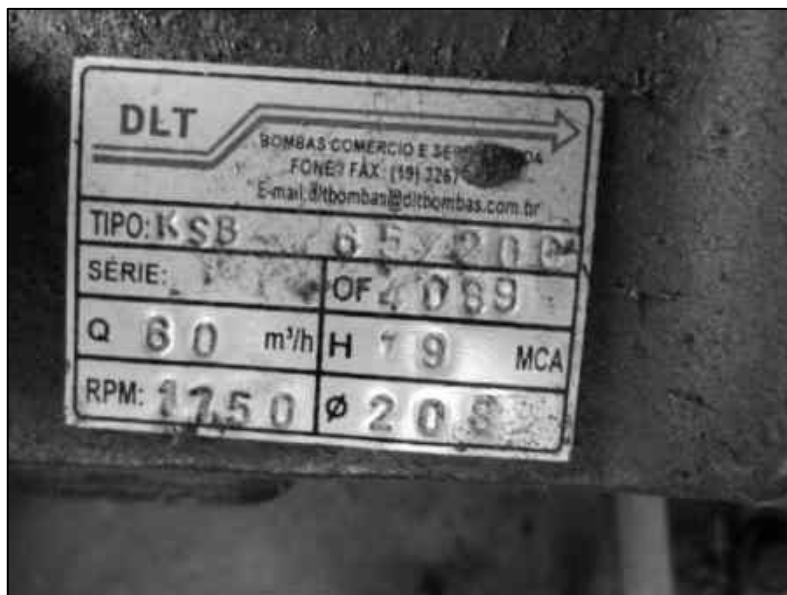
Figura 2.106 – Características técnicas do conjunto motor bomba reserva – ETA IV.
