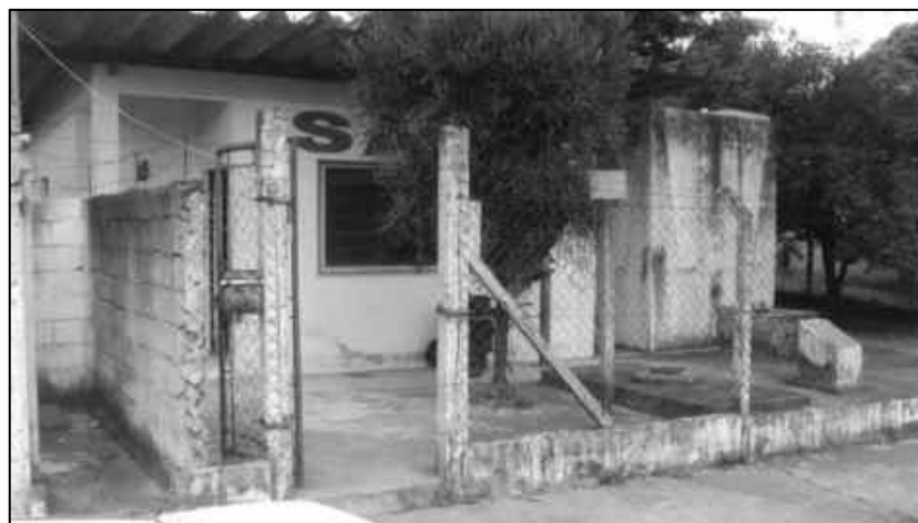
Figura 2.22 - Reservatório de Recalque “Moreirinha” – Alvenaria (ETA I) – 30 m 3 .
