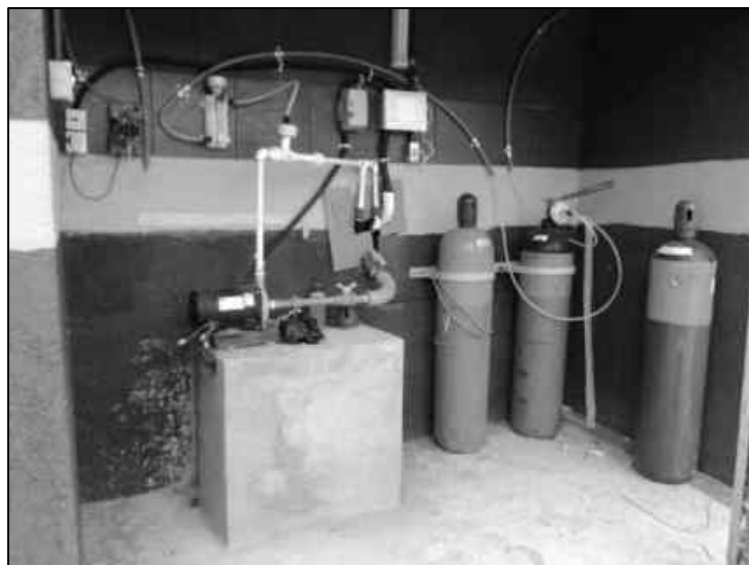
Figura 2.113 - Sistema de desinfecção por cloro gasoso – ETA IV.
