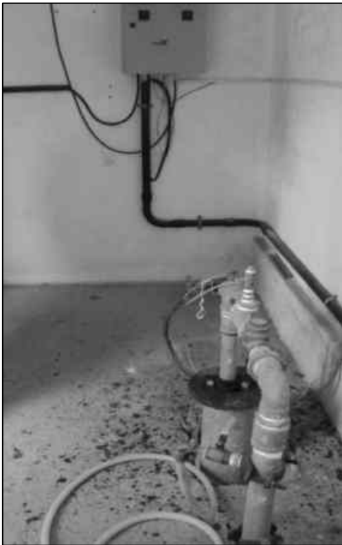
Figura 2.124 – Poço Artesiano Beira Rio – Poço e Recalque Juntos.
