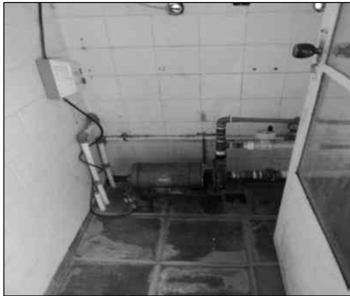
Figura 2.92 – Dosador de Cloro Gasoso.
