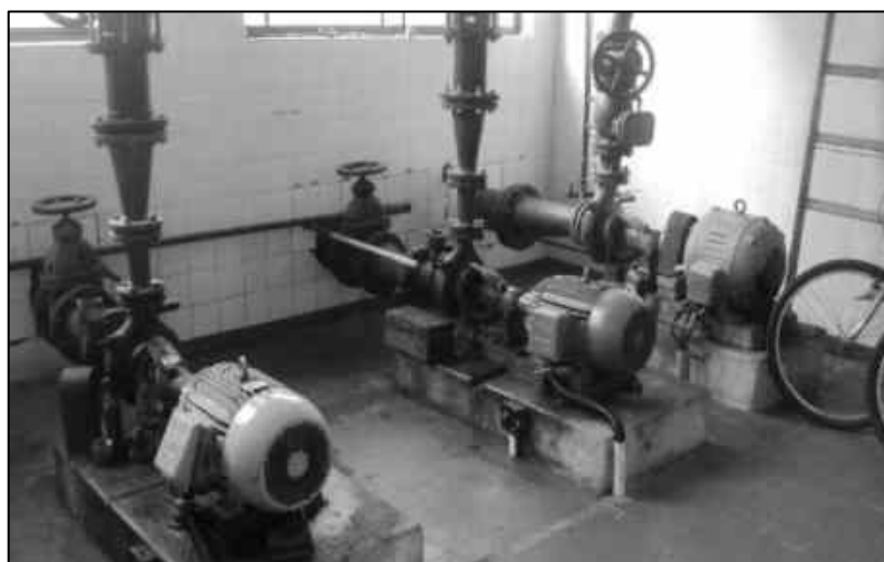
Figura 2.66 – Conjunto motor bomba do recalque Pinheirinho – ETA II.
