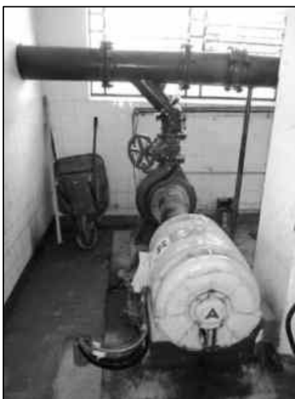
Figura 2.9 - Conjunto motor bomba reserva da ETA I.
