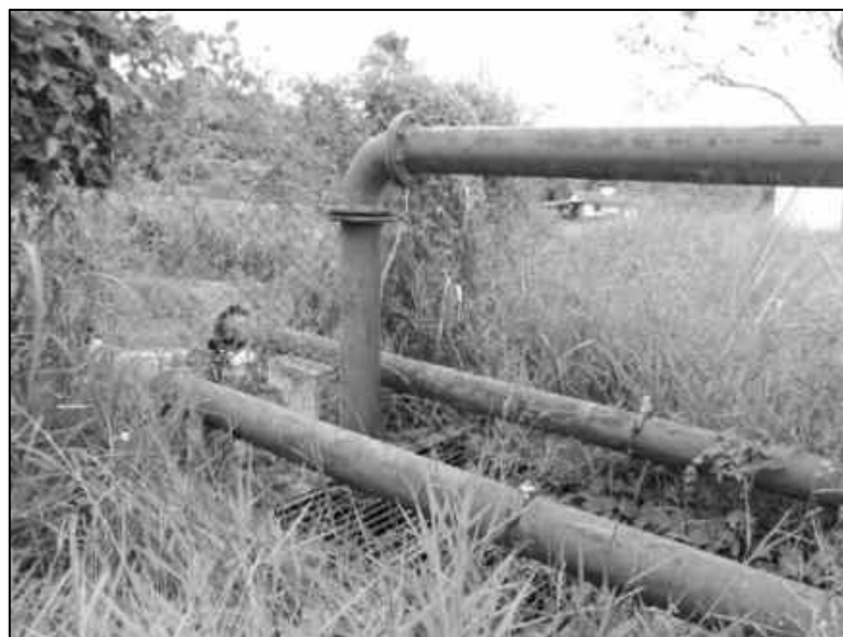
Figura 2.103 – Tubulações para a adução de Água Bruta captada – ETA IV.
