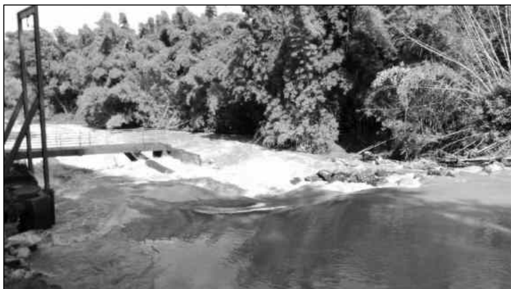
Figura 3.1 - Barragem de contenção parcialmente arrastada pelo fluxo d'água.
