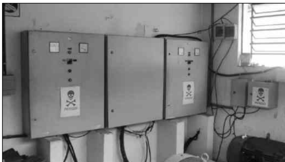
Figura 2.39 – Painel de Controle dos Conjuntos Motor Bomba – Jd. Figueira.
