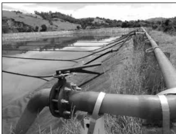
Figura 2.131 – Equipamentos para Aeração da Lagoa de Tratamento.
