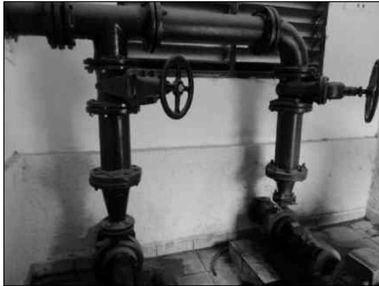
Figura 2.115 - Conjunto motor bomba para o recalque da água tratada - ETA IV.
