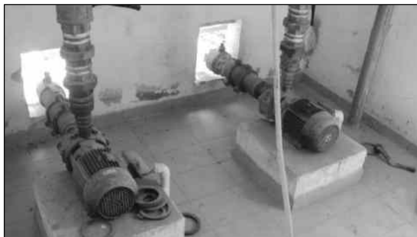
Figura 2.30- Conjunto motor bomba da estação de recalque Pq. Das Aves – ETA I.
