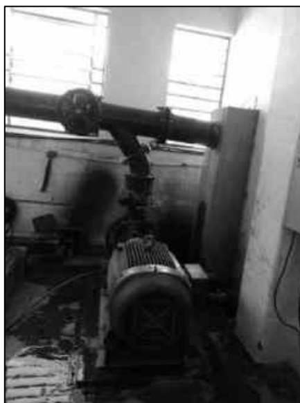
Figura 2.7 - Conjunto motor bomba em operação da ETA I.
