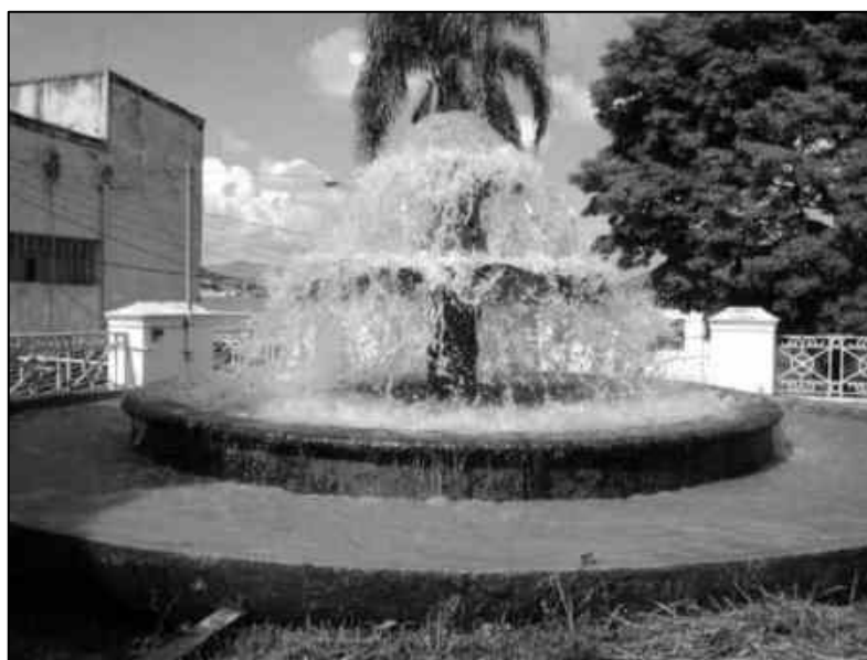
Figura 2.15 – Estrutura de chegada da Água Bruta – ETA I - Parque Dr. Arruda.
