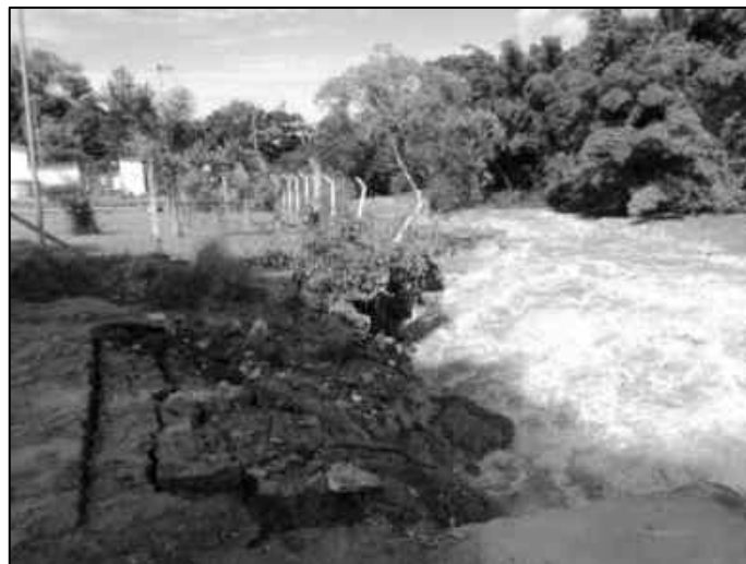
Figura 2.2 – Captação “Juca Bento” comprometida pela vazão do Rio Camanducaia.
