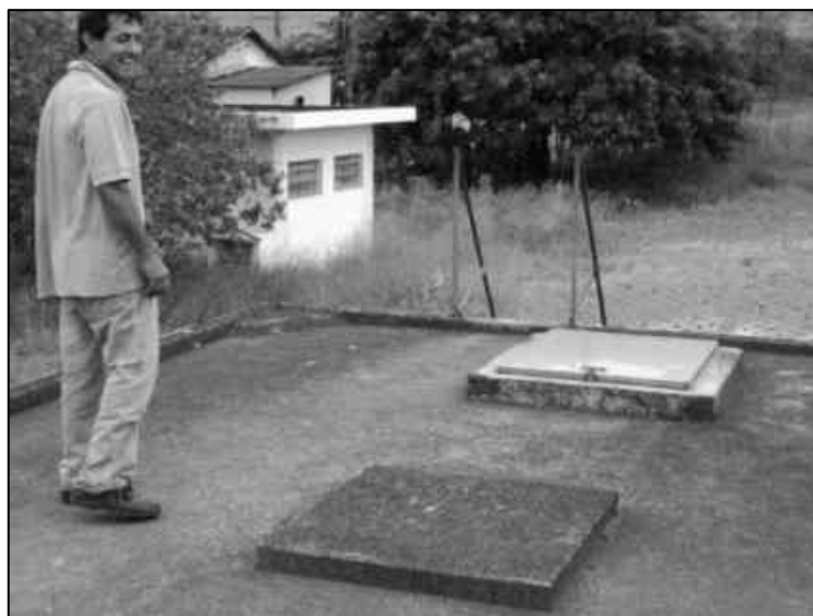
Figura 2.114 - Reservatório de distribuição utilizado como tanque de contato - ETA IV.
