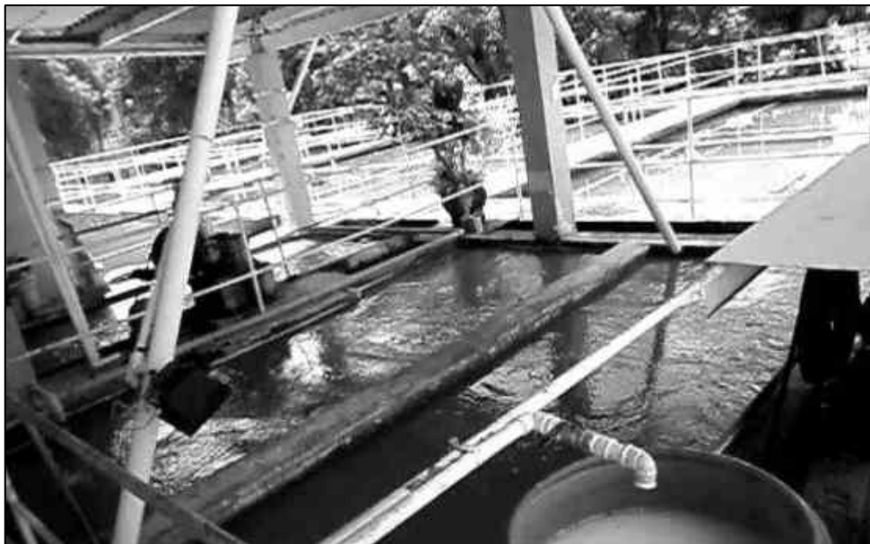
Figura 2.17 - Tanques de Floculação - ETA I - Parque Dr. Arruda.
