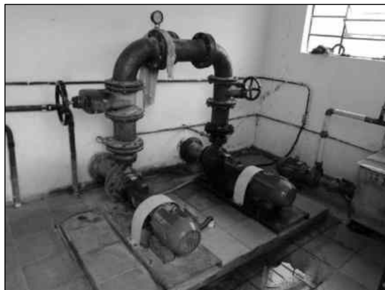
Figura 2.104 – Conjunto Motor Bomba para Captação de Água Bruta – ETA IV.
