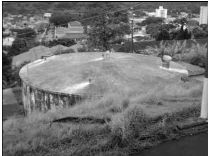
Figura 2.50 - Reservatório circular (ETA II) - 800 m 3 - Localizado Na Rua Carlos de Campos.
