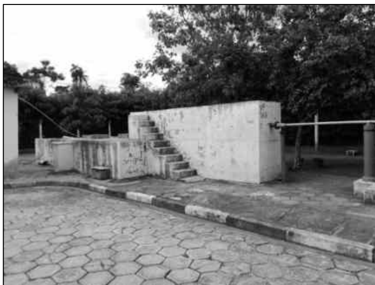
Figura 2.133 - Sistema de Tratamento da ETE do loteamento de Arcadas.
