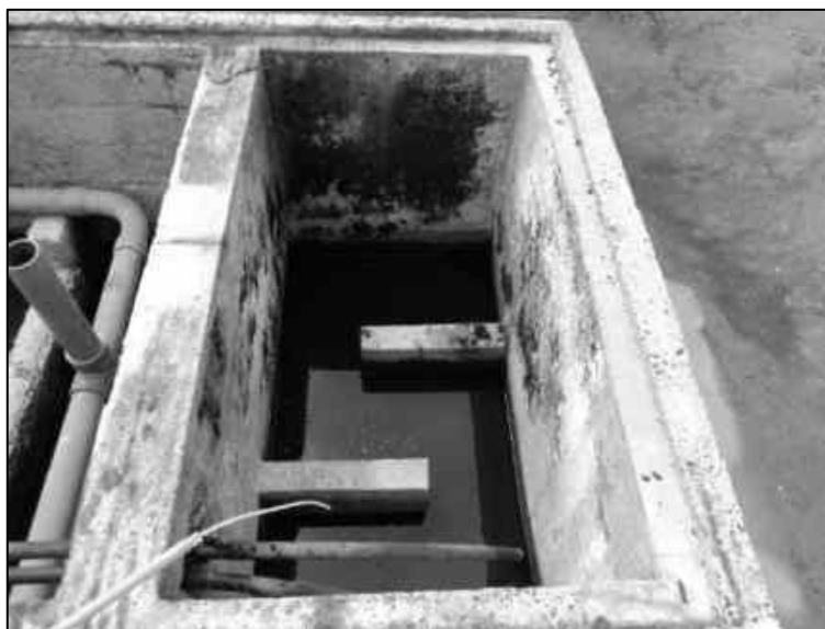
Figura 2.136 – Ponto de desinfecção do sistema de Tratamento da ETE.
