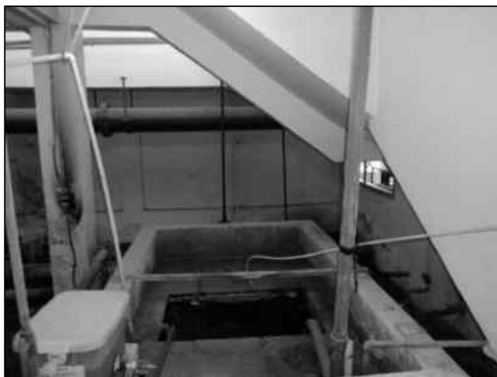
Figura 2.19 - Tanque para Dosagem de Produtos Químicos - ETA I - Parque Dr. Arruda.
