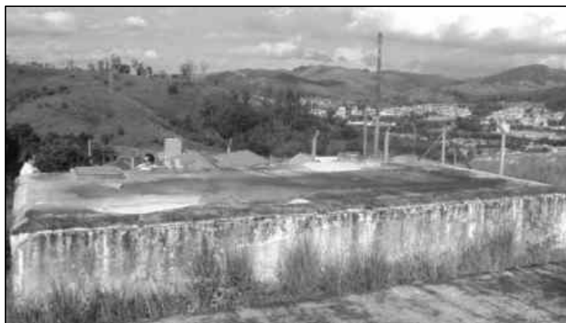
Figura 2.72 - Detalhe do reservatório Jd. Silmara (ETA II) – 100 m 3 - Estrutura de Alvenaria.
