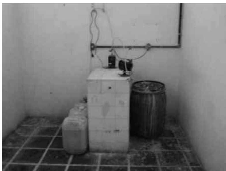
Figura 2.91 – Bombas dosadoras de sulfato de alumínio e ácido Fluossilícico.
