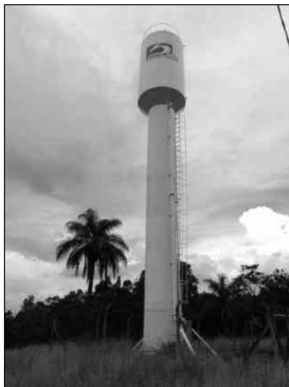
Figura 2.80 – Reservatório elevado Parque Modelo (ETA II), Av. José Domingues – 20 m 3 - Estrutura Metálica.
