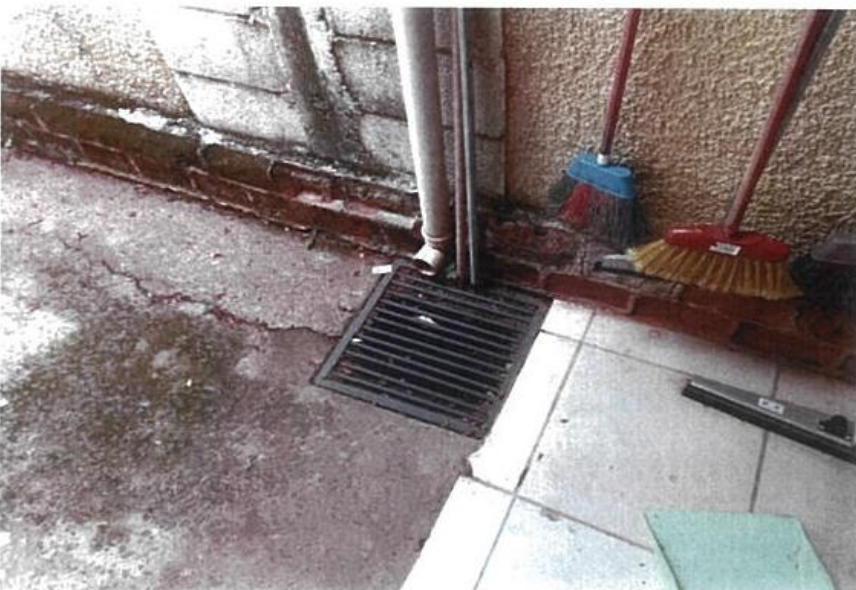
Foto 02 - Ralo trocado, conforme descrito ao item J. do presente documento.
