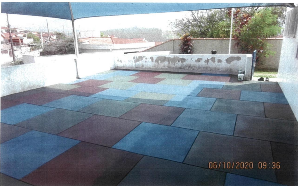
Foto 03 - Piso do solário trocado, conforme descrito ao item B. do presente documento.
