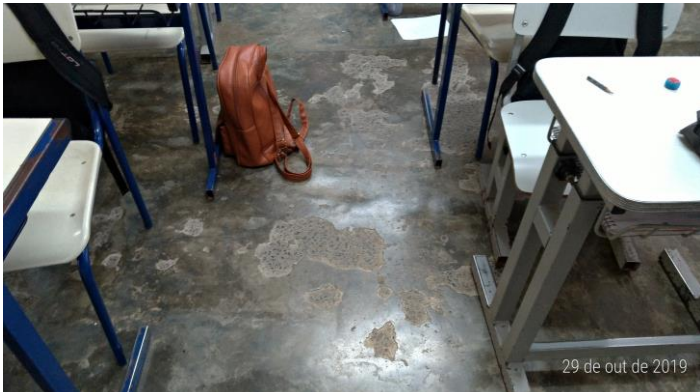
Foto 31 – Piso da sala de aula totalmente avariado.
