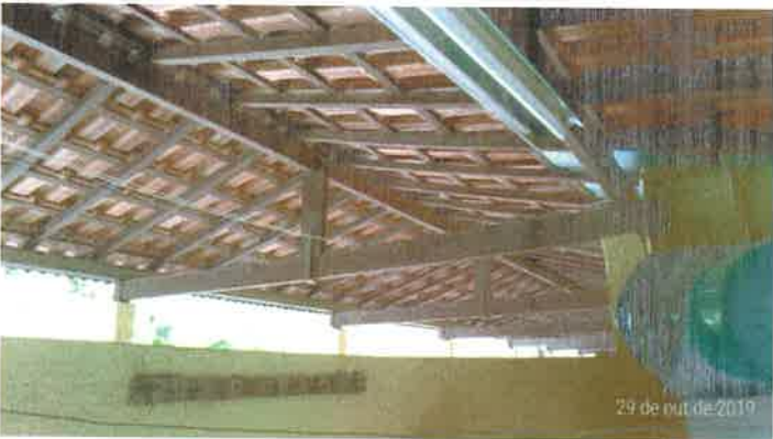
Foto 25 – Teto sem forro e com a presença de fezes de pássaros
