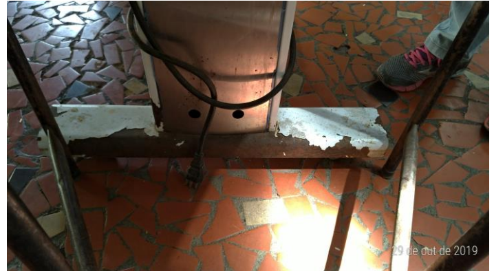
Foto 37 – Pé do balcão Self-Service enferrujado.
