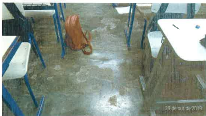
Foto 31 - Piso da sala de aula totalmente avariado
