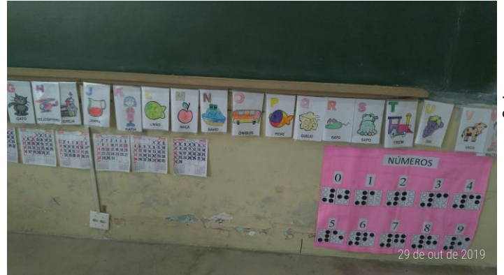
Foto 15 – Parede da Sala de Aula, parte inferior do quadro, danificada.
