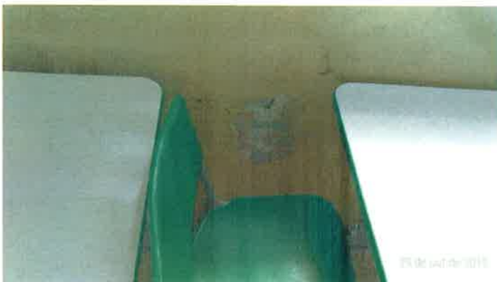
Foto 14 – Paredes da Sala de Aula descascadas.
