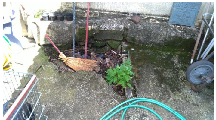
Foto 23 – Piso danificado e com a presença de entulhos no interior da escola.
