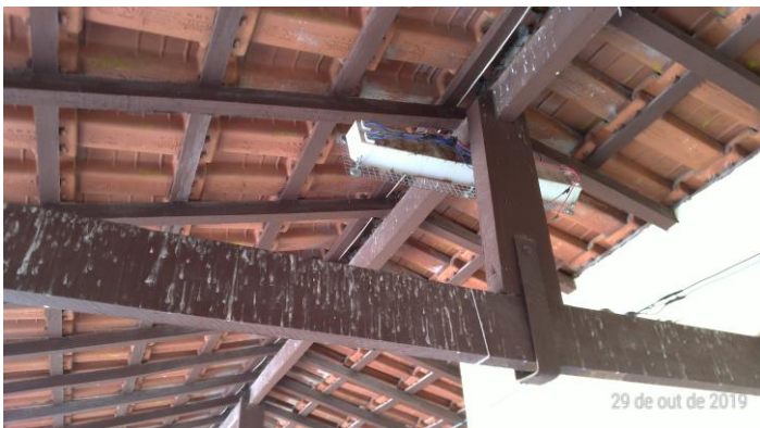
Foto 26 – Presença de fezes de pássaros no teto da área do pátio da escola.
