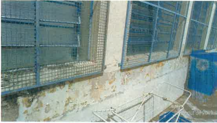
Foto 12 – Paredes exteriores da cozinha descascadas e janelas com grades metálicas.
