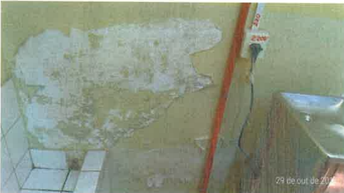
Foto 36 – Parede ao lado do bebedouro com sinais de infiltração e desbaste. Bebedouro sem indicação de troca de velas.
