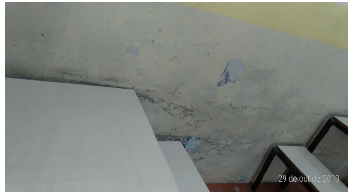
Foto 38 – Parede do refeitório descascada e com sinais de sujeira.
