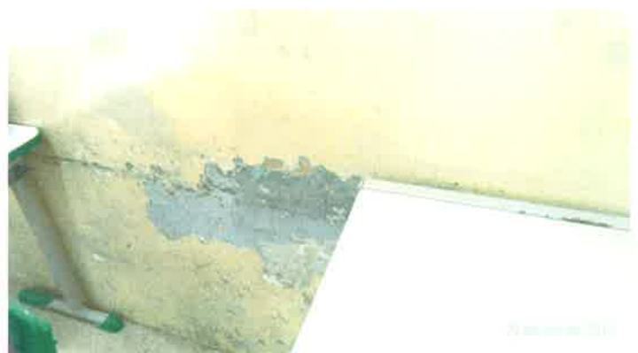
Foto 17 – Paredes descascadas e com sinais de infiltrações.
