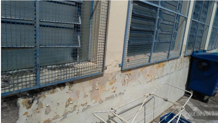
Foto 12 – Paredes exteriores da cozinha descascadas e janelas sem telas.
