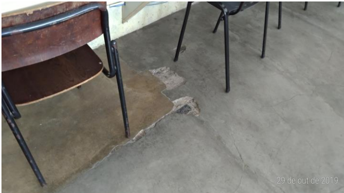
Foto 19 – Piso com buracos e trincas.
