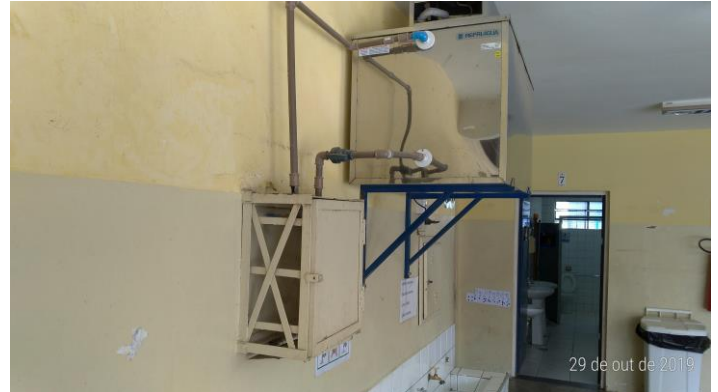
Foto 33 – Bebedouro sem indicação de datas de trocas das velas dos filtros.
