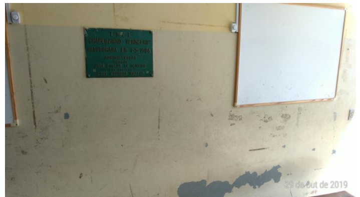
Foto 29 – Parede suja e descascada.
