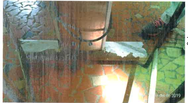
Foto 37 – Pé do balcão com sinais de ferrugem.
