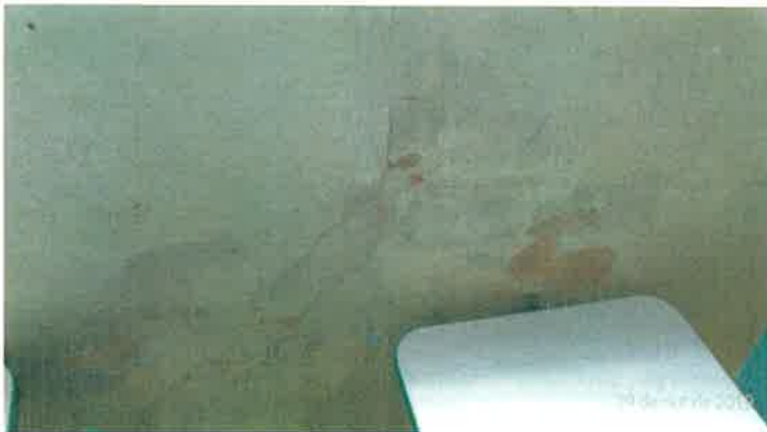
Foto 13 – Paredes da Sala de Aula descascadas.
