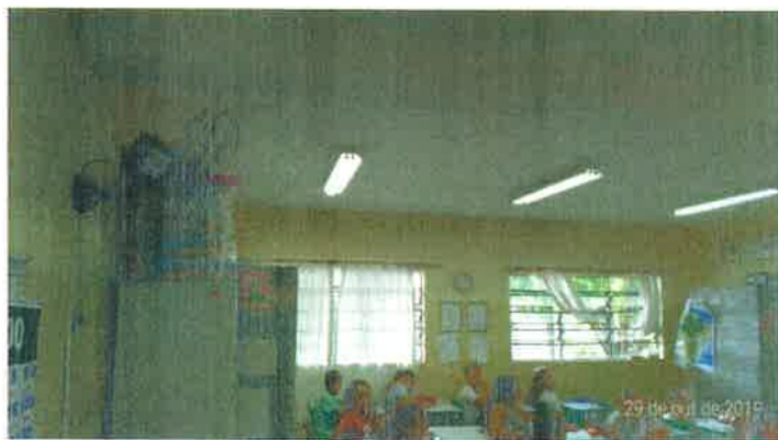
Foto 32 - Sala de Aula, cujos ventiladores não funcionavam.
