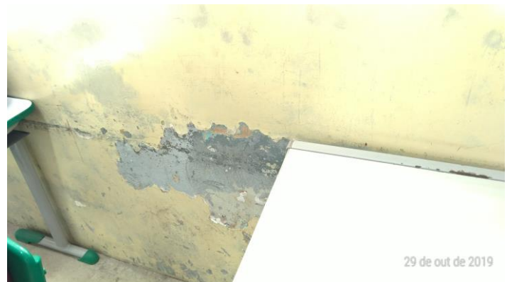
Foto 17 – Parede descascada e com sinais de infiltrações.
