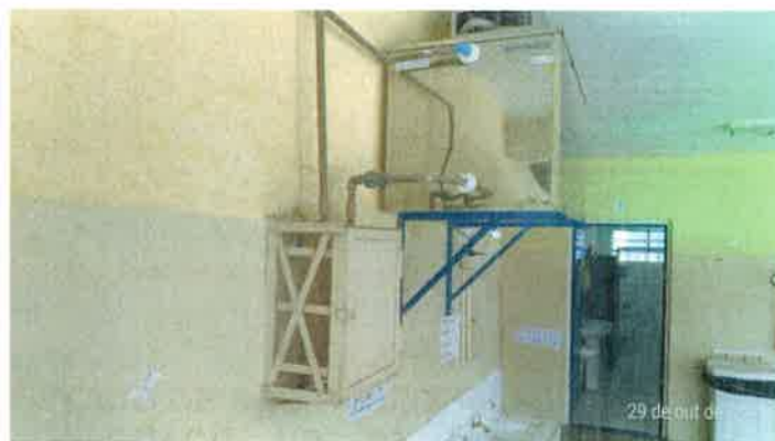
Foto 33 - Bchedour com indicação de datas de trocas das velas dos filtros.
