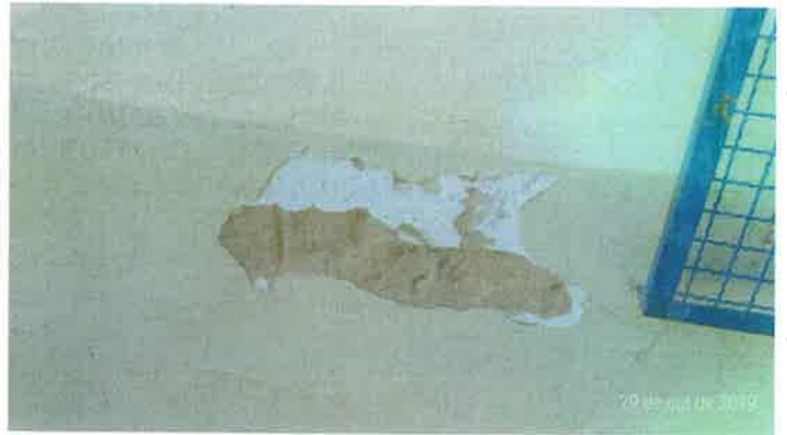
Foto 24 – Parede com manchas
