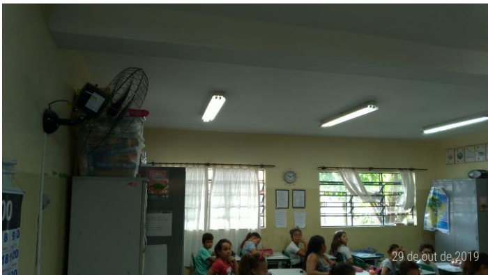
Foto 32 – Sala de Aula, cujos ventiladores não funcionavam adequadamente.
