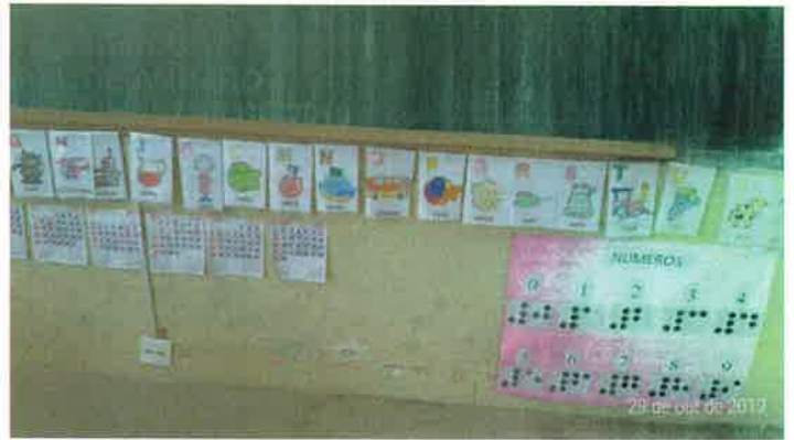
Foto 15 – Paredes da Sala de Aula, parte inferior do quadro, danificada.
