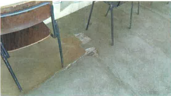
Foto 19 – Piso com buracos e trincas.
