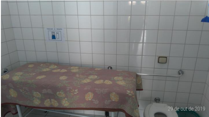
Foto 30 – Trocador infantil coberto por tecido permeável, localizado no interior do banheiro de uso comum dos alunos.
