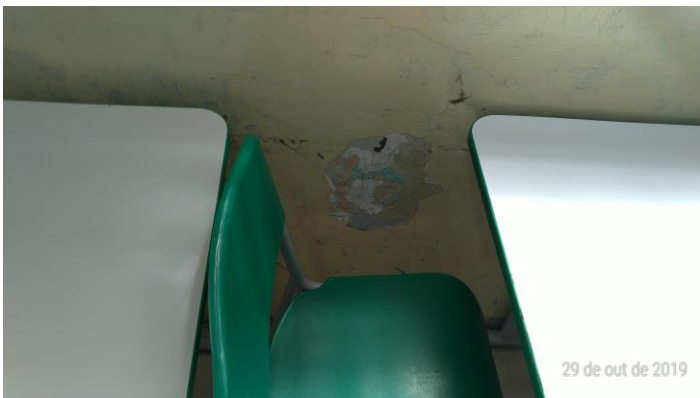
Foto 14 – Parede da Sala de Aula descascada.
