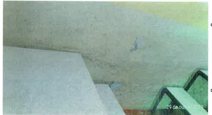
Foto 38 – Escada com sinais de sujeira.
