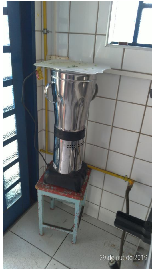
Foto 10 – Uso de equipamentos em local inapropriado.
