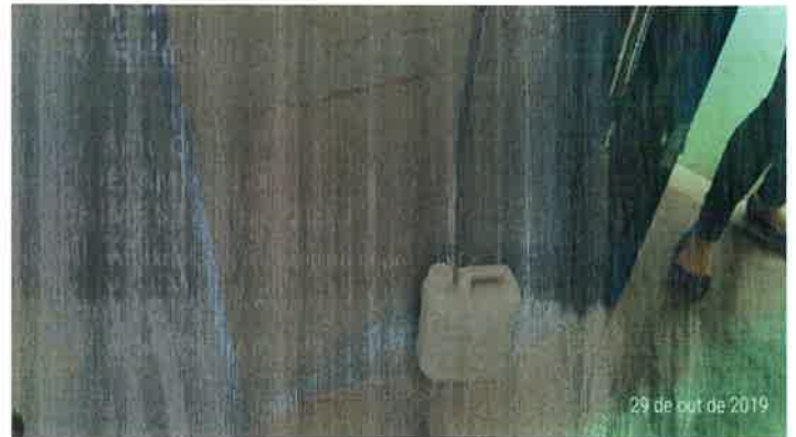
Foto 15 – Armário com fechamento improvisado.
