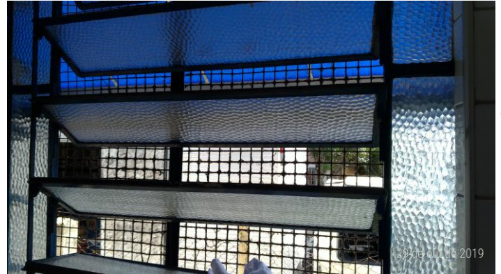
Foto 04 – Janela da cozinha sem tela milimetrada de proteção contra insetos.
