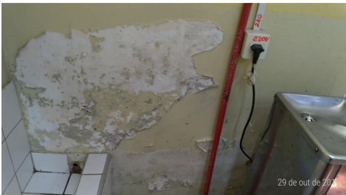
Foto 36 – Parede ao lado do bebedouro com sinais de infiltrações e descascada. Bebedouro sem indicação de troca de velas.
