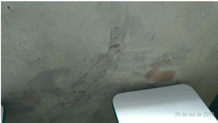
Foto 13 – Parede da Sala de Aula descascada.
