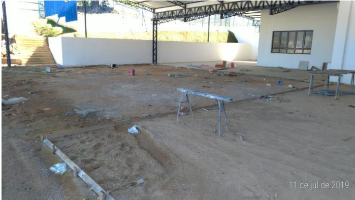
Foto 01 – Local onde será o refeitório da escola. Não há sequer contrapiso no local.
