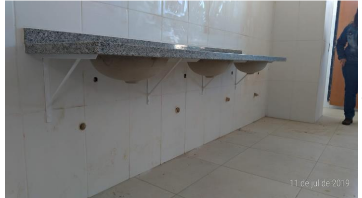
Foto 04 – Foto da pia de um dos banheiros, sem torneiras e sem sifões instalados.
