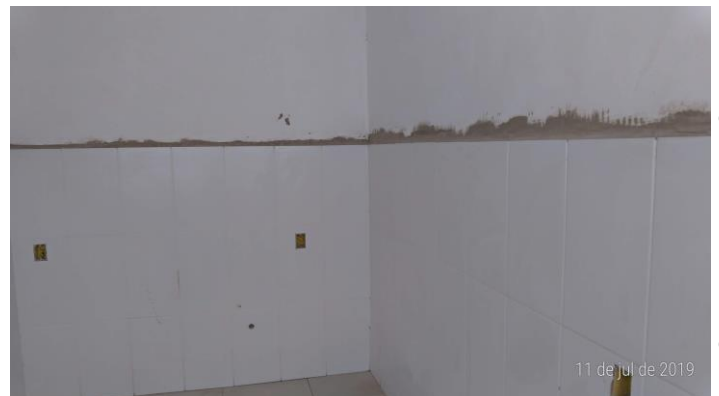
Foto 05 – Parede sem a pintura correta e sem instalações elétricas.
