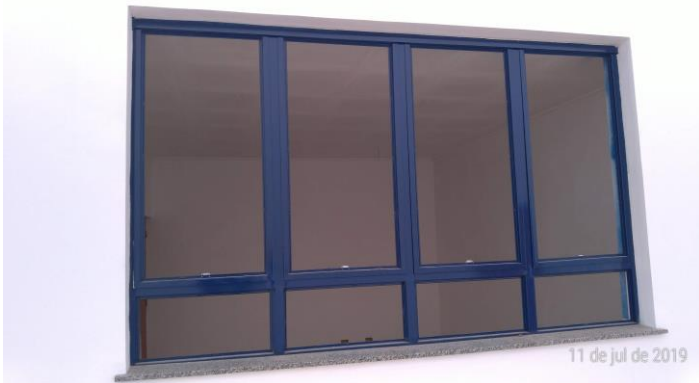
Foto 03 – Janela sem colocação de vidros
