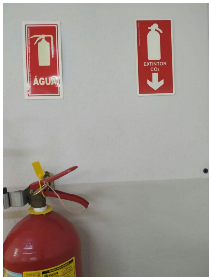
Extintor sem manômetro
