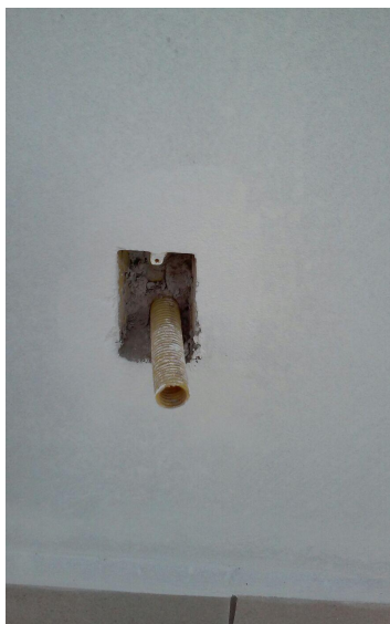
Rede elétrica ainda não concluída
